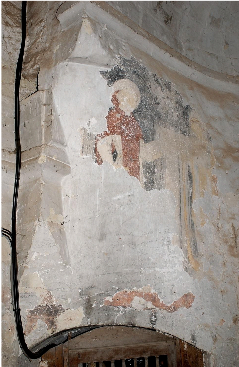
Chapelle sud, absidiole, mur nord : vue d'ensemble des deux saints.
