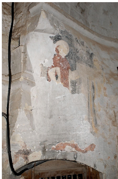
Chapelle sud, absidiole, mur nord : vue d'ensemble des deux saints. Phot. Bruno Rousseau IVR52_20044900670NUCA
