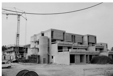
Vue du chantier de construction des immeubles à gradins aux Bruyères. Repro. Pierre-Bernard Fourny IVR52_20237201821NUCA
