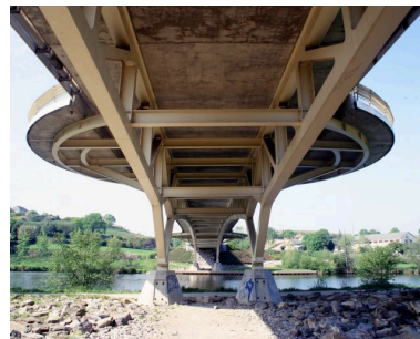
Vue de la structure métallique, sous le tablier, depuis la rive droite. Phot. François Lasa IVR52_20025300604XA
