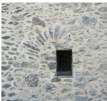
Un arc de décharge. Phot. Pierre-Bernard Fourny IVR52_20215301203NUCA
