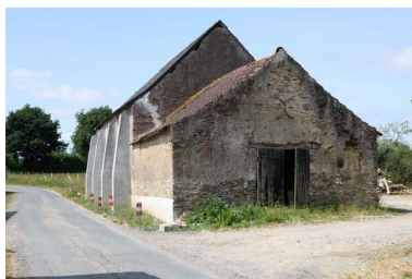
Vue de la grange-étable depuis le nord, Petite Touche Fleury. Phot. Armelle Maugin IVR52_20254900654NUCA
