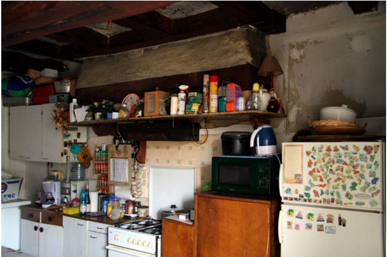
Cheminée de la cuisine.
