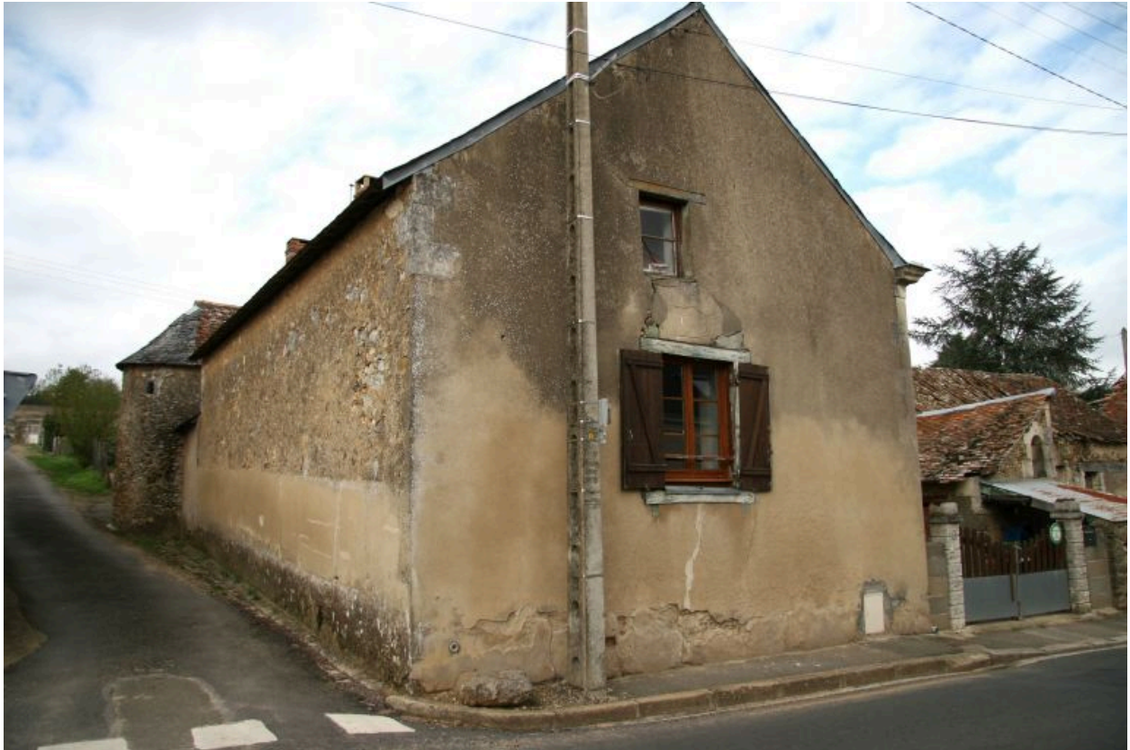
Vue de volume : maison à l'angle avec le chemin du nouveau cimetière.
