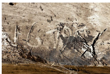
Logis nord, date 1679 gravée dans le linteau intérieur de la porte. Phot. Yves Guillotin IVR52_20215301773NUCA
