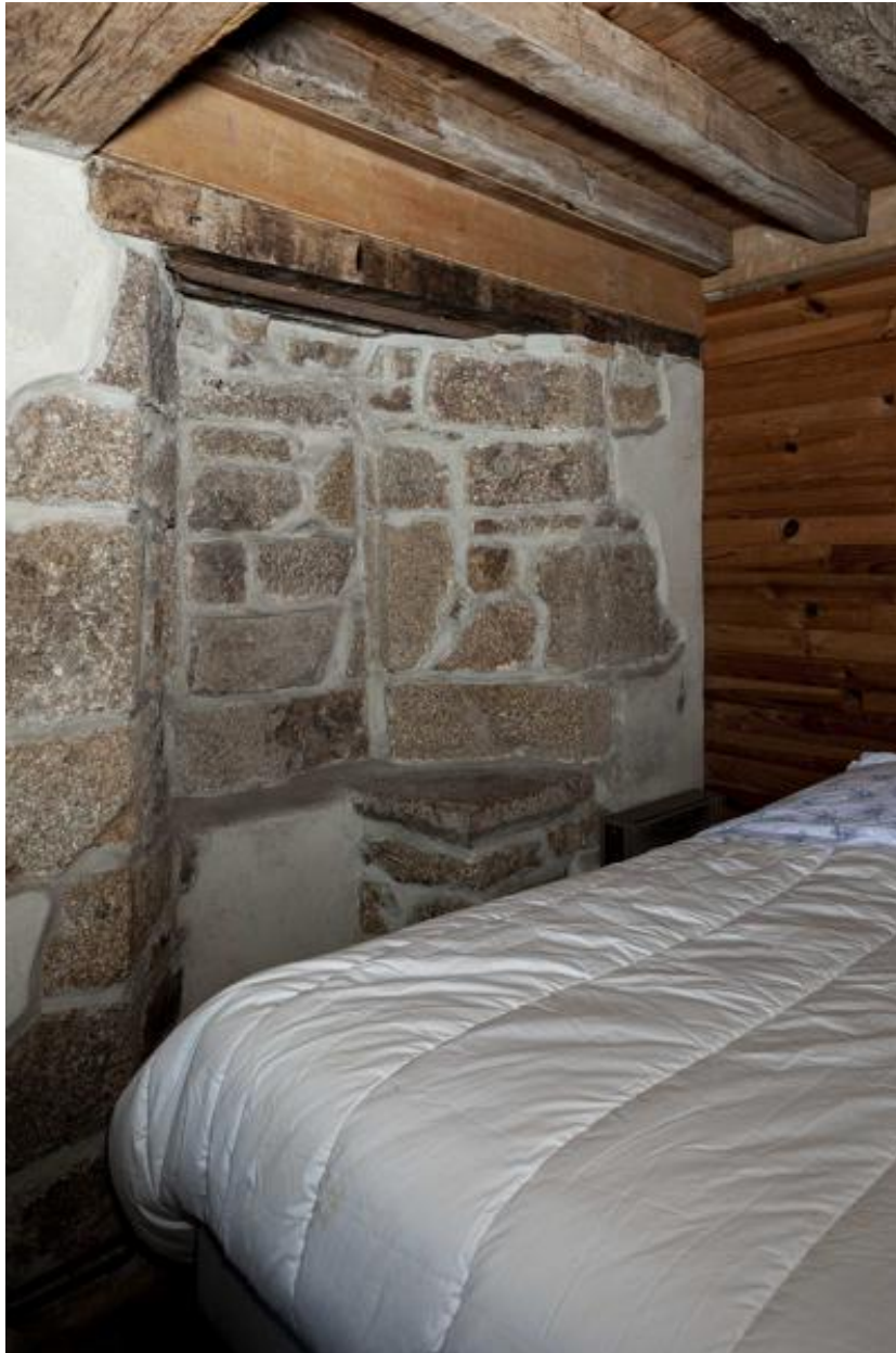
Logis sud, fenêtre bouchée à coussiège dans l'ancien mur-gouttereau ouest, au premier étage.
