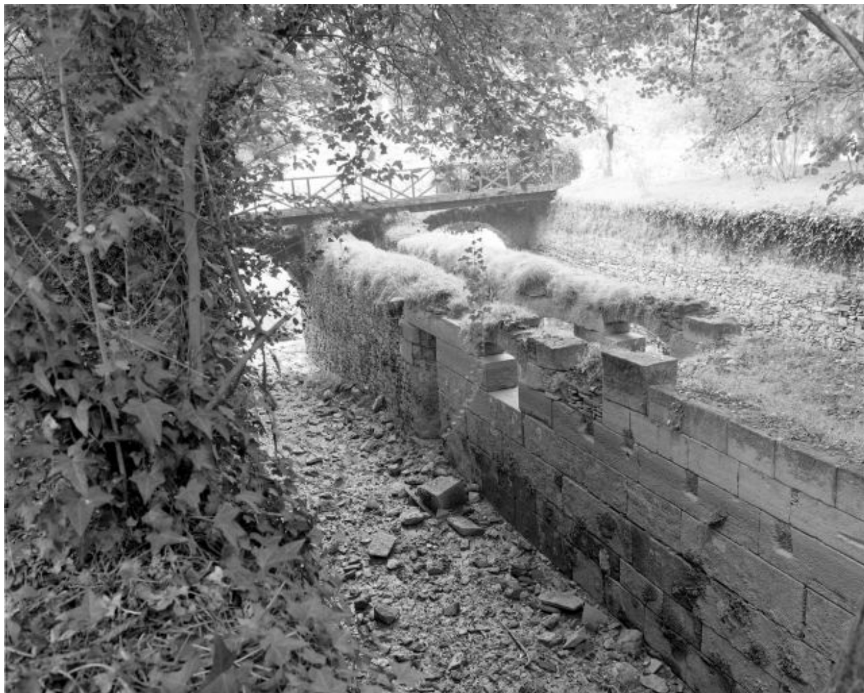
Le coursier latéral sud vu du sud-est : mur bajoyer nord. A droite, le coursier central et le coursier latéral nord.
