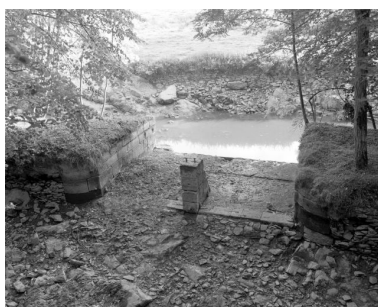
Vannes de décharge. Phot. François Lasa IVR52_19855300320X
