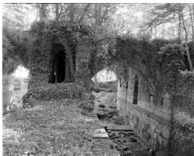
Le coursier central et le coursier latéral nord vus de l'ouest. Phot. François Lasa IVR52_19855300327X
