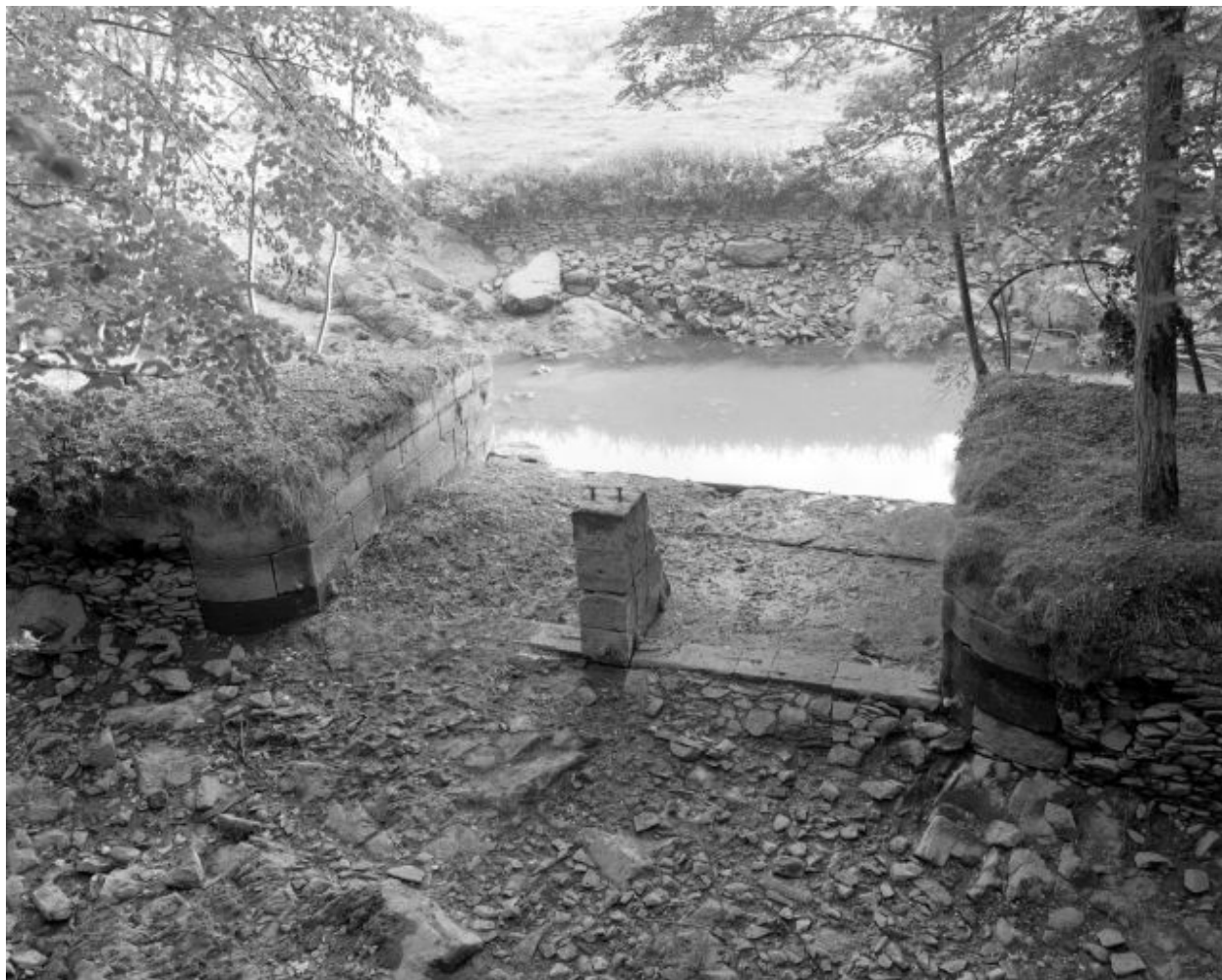
Vannes de décharge.
