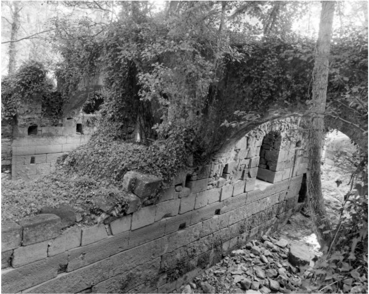
Le coursier latéral sud vu du sud-ouest : mur bajoyer nord, arc. A gauche, le mur bajoyer nord du coursier latéral nord.
