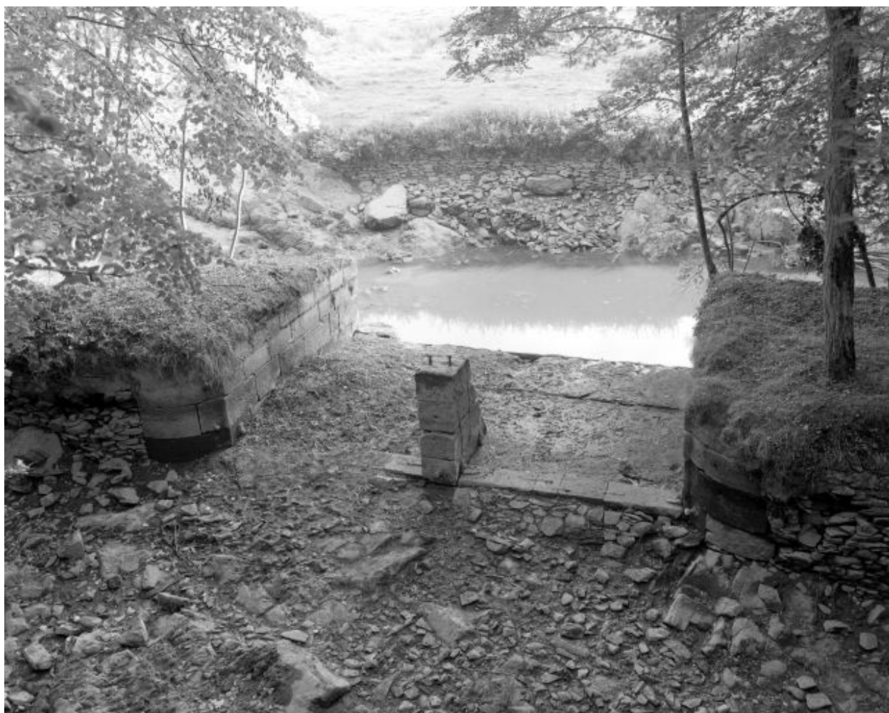
Vannes de décharge.
