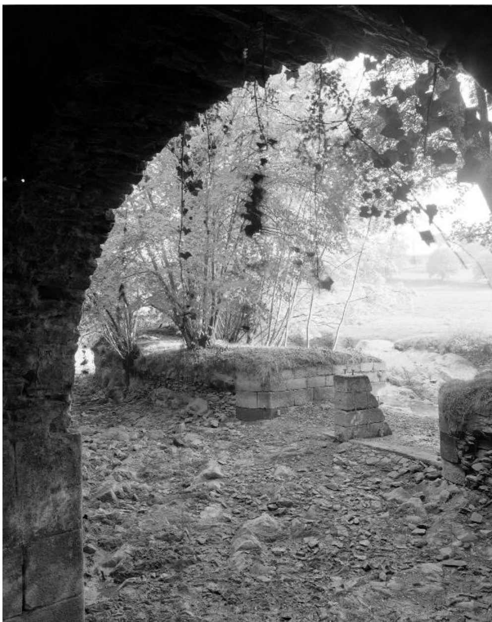
Vannes de décharge.
