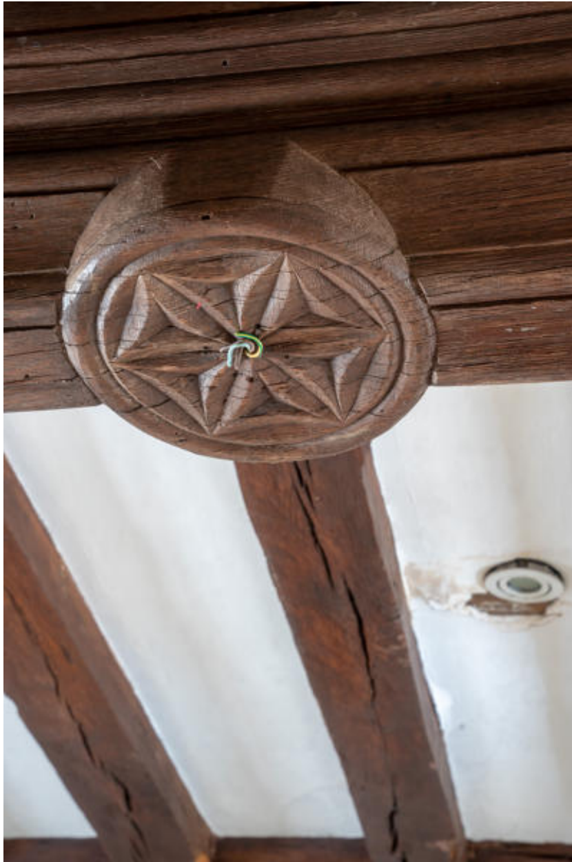
Un détail des moulures du plafond dans la salle dite d'Héliand (au-dessus de l'ancien porche).
