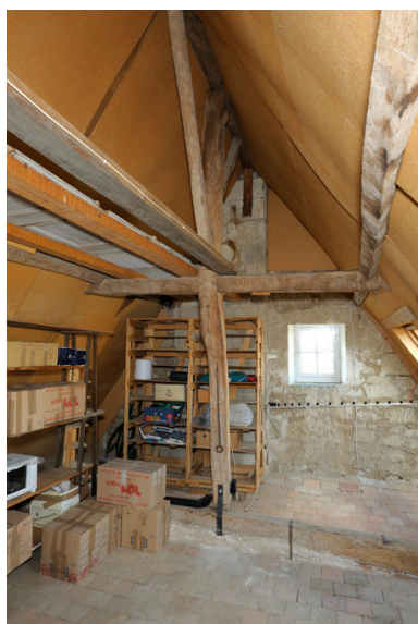
Charpente du corps ouest : on note les pannes sous arbalétrier, maintenues par une encoche dans l'entrait retroussé. Phot. Bruno Rousseau, Phot. Youenn Communeau IVR52_20124901315NUCA
