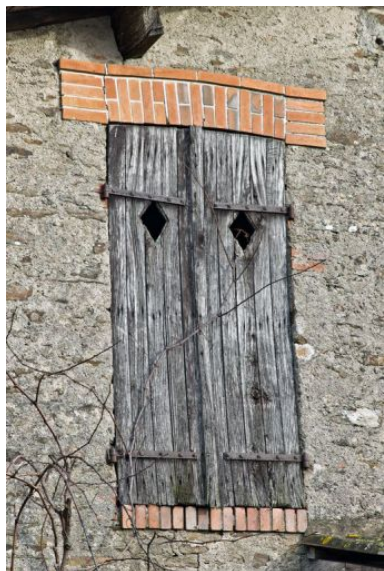
Baie à encadrement de brique, fin 19e-début 20e siècles. (La Hautière) Phot. Yves Guillotin IVR52_20124400009NUCA
