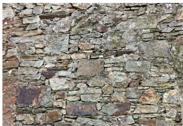
Appareillage irrégulier de moëllons de schiste, 18e siècle. (La Hautière) Phot. Yves Guillotin IVR52_20124400005NUCA
