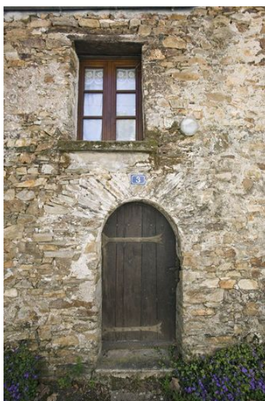
Porte cintrée à arc de schiste et fenêtre à linteau de bois, 18e siècle. (La Bourchinière). Phot. Yves Guillotin IVR52_20114400591NUCA
