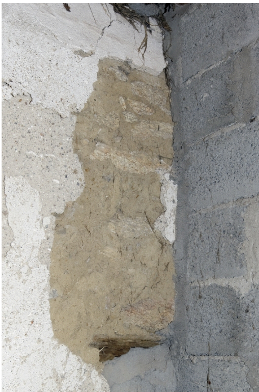
N° 10 rue Basse. Étage. Détail de l'un bouchage de torchis.
