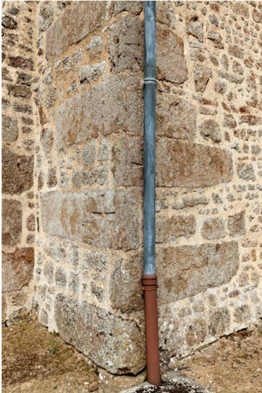
Chaîne d'angle sud-ouest de l'église Saint-Fraimbault de Saint-Fraimbault de Lassay, remploi de pierres tombales
