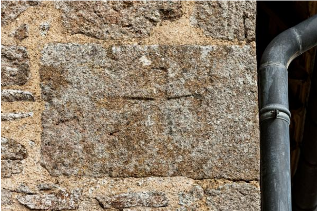
Chaîne d'angle sud-ouest de la nef de l'église Saint-Fraimbault de Saint-Fraimbault de Lassay, remploi d'une pierres tombales
