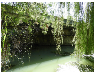
Le pont sur le Contrebot vu depuis le nord. Phot. Yannis Suire IVR52_20198500376NUCA
