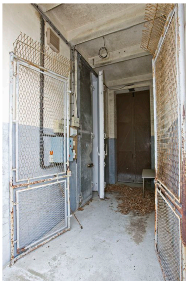
L'entrée de l'édicule en béton pour la salle réfrigérée. Phot. Yves Guillotin IVR52_20117200722NUCA
