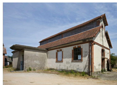
Le bâtiment principal, façade antérieure : un édicule en béton abritant une pièce froide est ajouté. Phot. Yves Guillotin IVR52_20117200749NUCA
