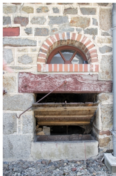
Ouverture d'alimentation de la nouvelle porcherie. Phot. François Lasa IVR52_20065300713NUCA
