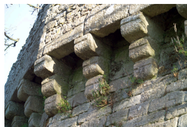
Détail des consoles portant le chemin de ronde. Phot. Denis Pillet IVR52_20054402210NUCA
