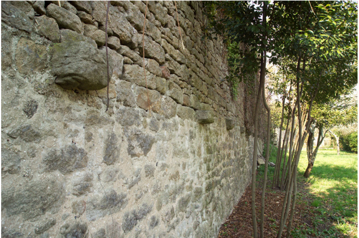
Enceinte urbaine entre les tours de la Gaudinais et de l'Abreuvoir, corbeaux.
