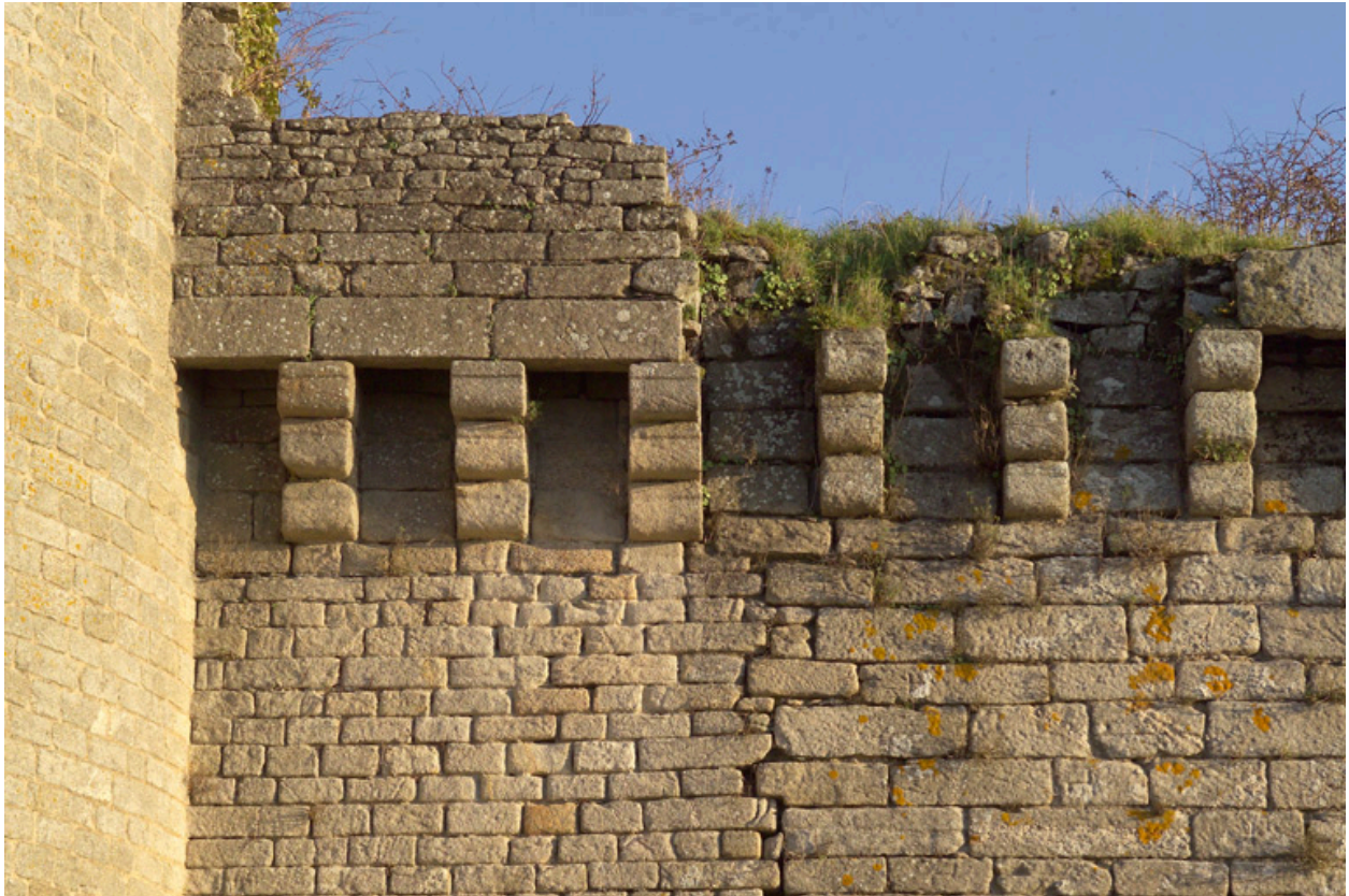
Changement d'appareil à la jonction de la tour de la Gaudinai et de l'enceinte contigüe.
