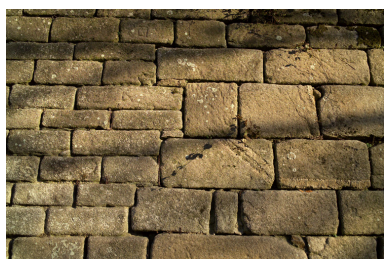
Détail de la rupture d'appareil à la jonction de l'enceinte et de la tour disparue. Phot. Denis Pillet IVR52_20054402219NUCA
