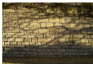
Rupture d'appareil à la jonction de l'enceinte et de la tour disparue. Phot. Denis Pillet IVR52_20054402215NUCA
