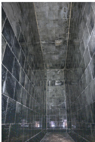
Intérieur d'une cuve verrée. Phot. Pierre-Bernard Fourny IVR52_20214400288NUCA
