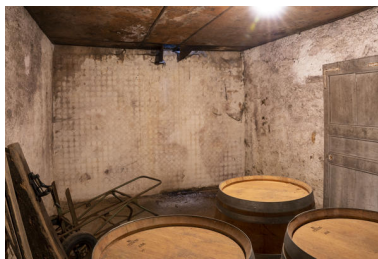
Détail d'une cellule de stockage des bouteilles. Phot. Pierre-Bernard Fourny IVR52_20214400271NUCA
