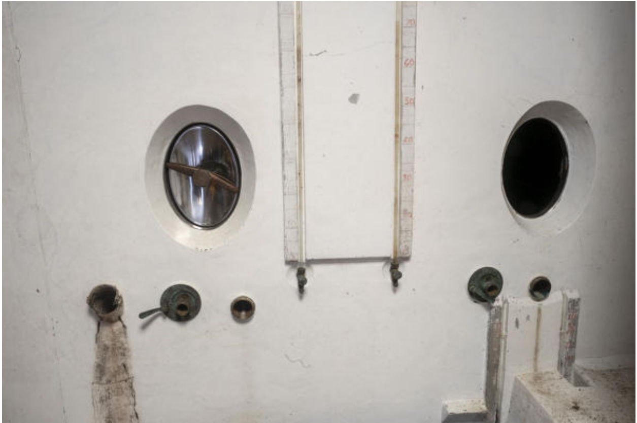
Détail de la cuverie, au premier étage.
