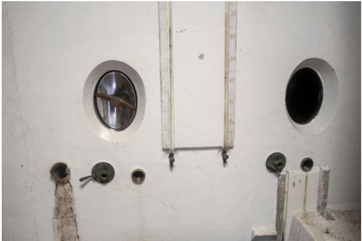
Détail de la cuverie, au premier étage.
