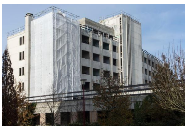
Vue de l'ancienne clinique des sœurs de la Solitude réhabilitée en immeubles à logement. Phot. Bruno Rousseau IVR52_20207200963NUCA
