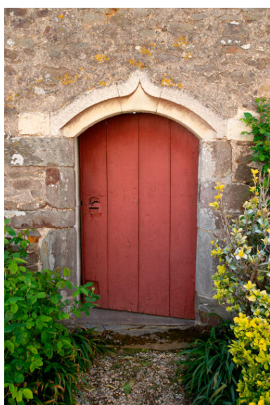
La porte de la chapelle. Phot. Pierre-Bernard Fourny IVR52_20235300285NUCA
