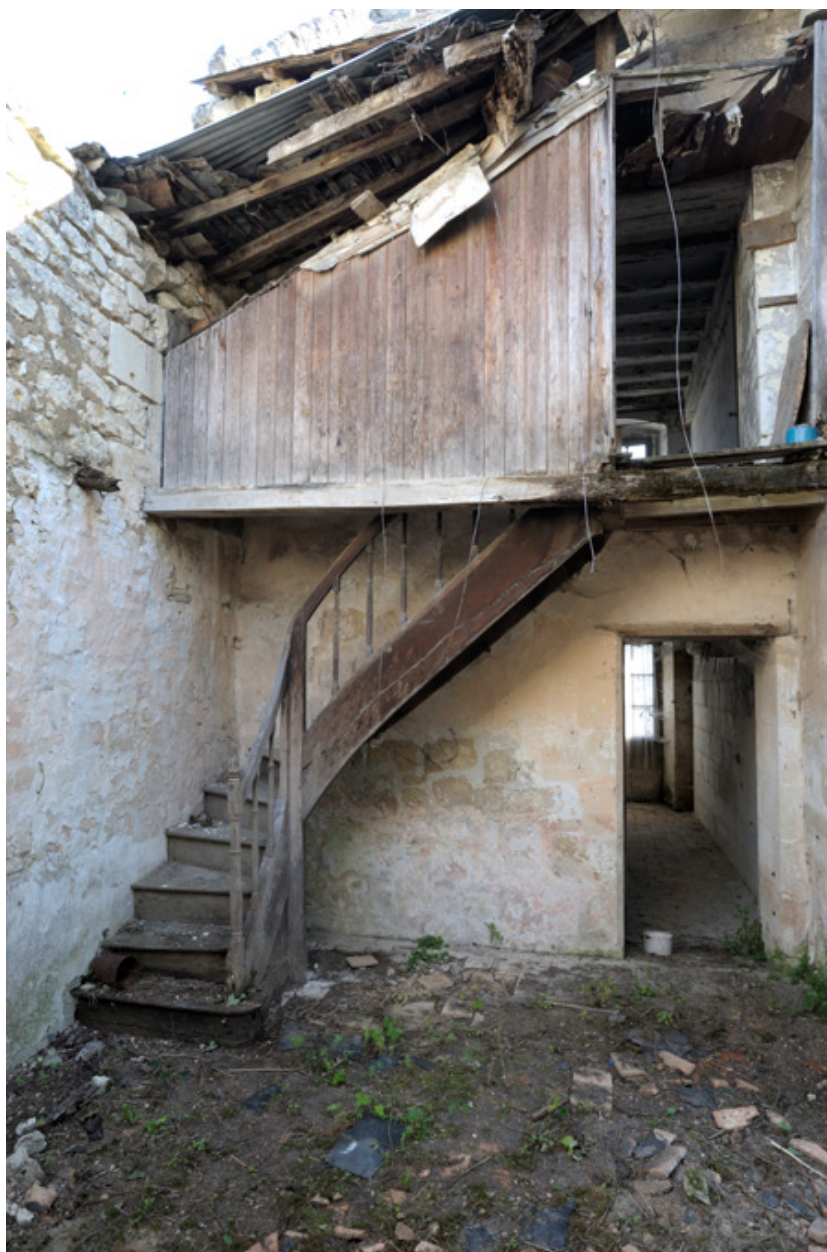
Appentis, ruiné. Escalier intérieur, tournant et en charpente (XIXe siècle), de communication avec l'étage et avec le logis.
