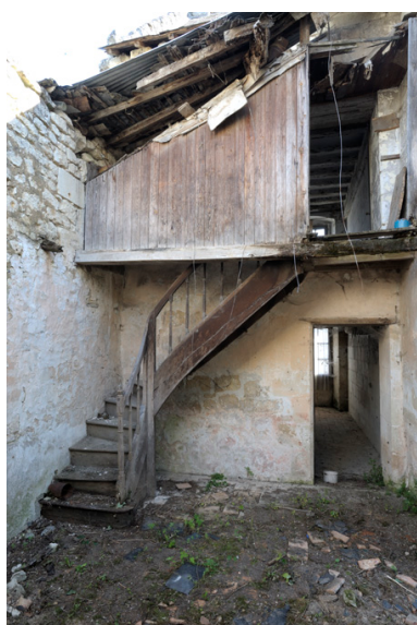
Appentis, ruiné. Escalier intérieur, tournant et en charpente (XIXe siècle), de communication avec l'étage et avec le logis. Phot. Bruno Rousseau IVR52_20124901521NUCA
