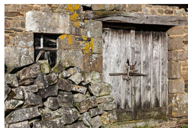
Hameau du Baz-Hazay, porte et fenêtre de l'ancienne maison de l'alignement nord, transformée en remise. Phot. Yves Guillotin IVR52_20195300333NUCA
