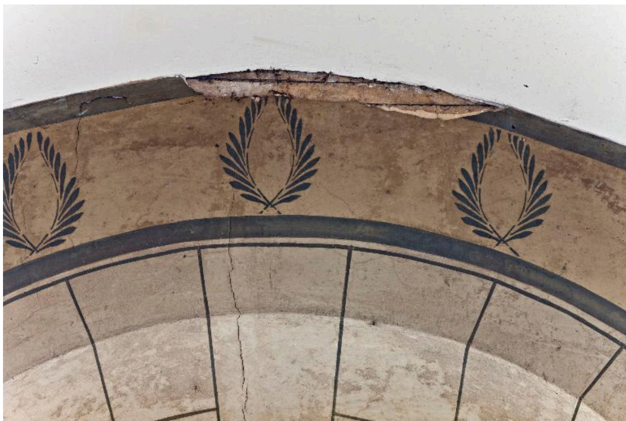
Bras nord du transept, mur nord, le monument aux morts, détail : décollement de l'extrémité supérieure.
