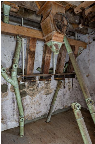
Deuxième étage, partie nord- ouest : les ensacheurs à son vus depuis le sud-est. Phot. Yves Guillotin IVR52_20205300007NUCA
