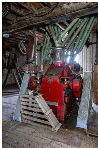
Deuxième étage, partie nord-est vue depuis le sud-est : paire de broyeurs à cylindres, de la marque SOCAM, installée dans les années 1970. Phot. Yves Guillotin IVR52_20205300009NUCA
