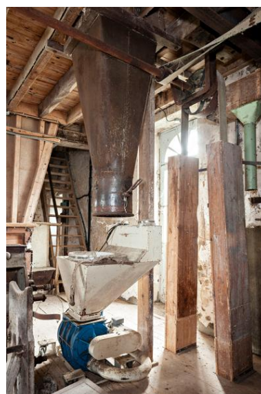
Premier étage, partie sud-ouest vue depuis le nord-est : au premier plan, l'ensacheur à farine de blé qui a fonctionné jusqu'au début des années 1980 et dans lequel tombait la farine stockée dans la chambre ronde située au-dessus. Phot. Yves Guillotin IVR52_20205300020NUCA
