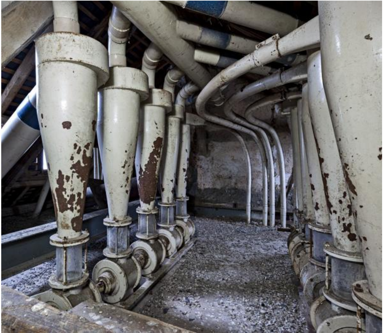
Comble, partie nord vue depuis le sud : le système pneumatique.
