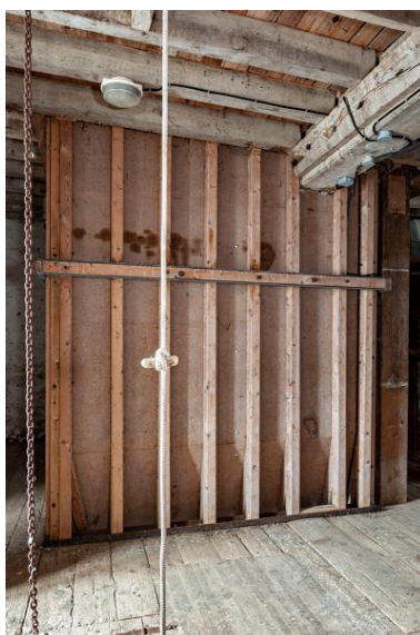
Deuxième étage, partie sud-ouest : la chambre à farine installée en 1981, vue depuis l'est. Phot. Yves Guillotin IVR52_20205300017NUCA
