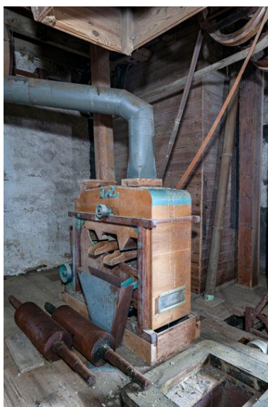
Deuxième étage, partie sud-est : le séparateur à blé et la chambre à blé sale vus depuis le nord-ouest Phot. Yves Guillotin IVR52_20205300013NUCA
