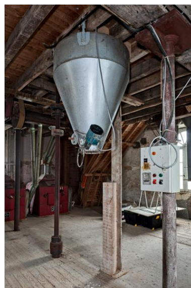
Premier étage, partie nord-est vue depuis le sud-ouest : au premier plan, l'ensacheuse-peseuse installée en mai 1981, achetée à Rodez (établissements Layrolle). Phot. Yves Guillotin IVR52_20205300023NUCA
