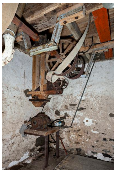
Rez-de-chaussée, angle nord-est : le moteur d'appoint de la roue (Moteurs Ch. Roulland, Vincennes, moteur asynchrone triphasé, type PL1202k, N°551947). Phot. Yves Guillotin IVR52_20205300025NUCA
