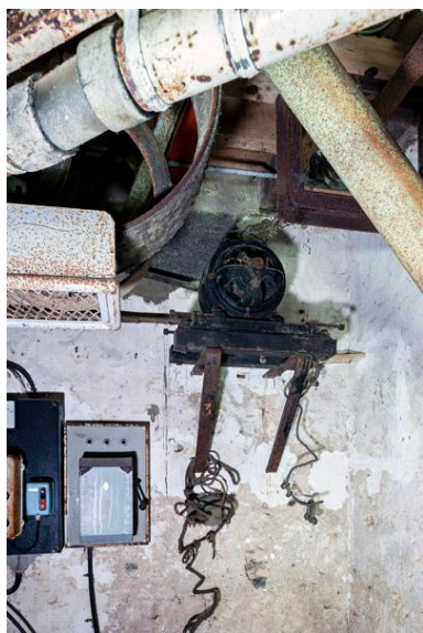
Rez-de-chaussée, mur ouest : dynamo qui était reliée à des batteries situées dans une dépendance et permettait, jusque vers 1955, l'éclairage du moulin et de la maison. Phot. Yves Guillotin IVR52_20205300027NUCA
