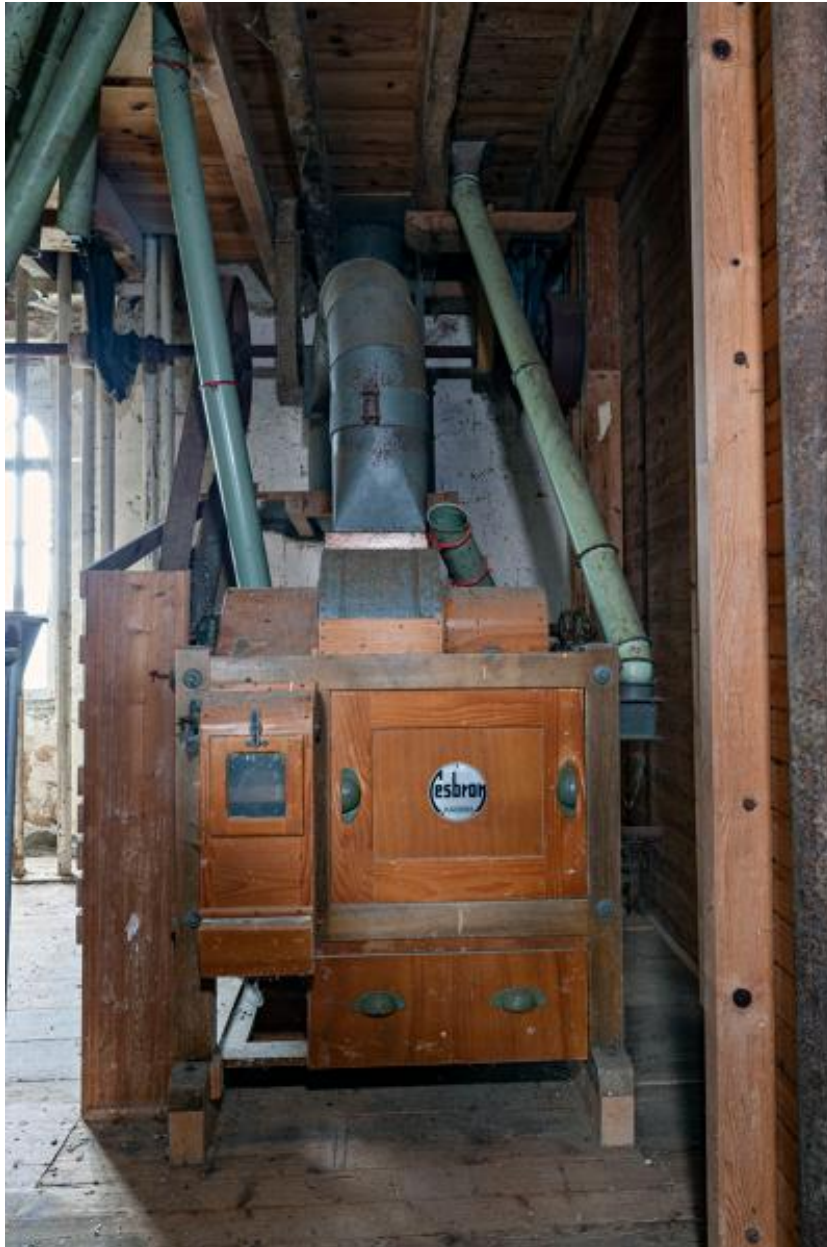
Deuxième étage, partie nord-est : la brosse à blé, de la marque Cesbron, vue depuis le sud. Installée vers 1958, elle est reliée à la chambre à blé propre.
