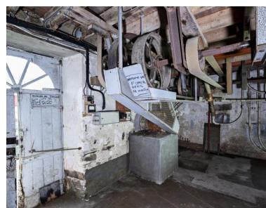
Rez-de-chaussée, partie nord-ouest vue depuis le sud : le moteur et les courroies transmettant le mouvement issu de la roue hydraulique et de ce moteur aux broyeurs à cylindres. Phot. Yves Guillotin IVR52_20205300059NUCA
