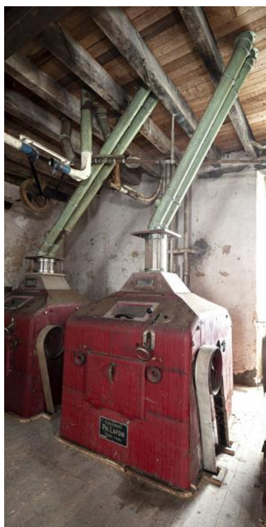
Premier étage, partie nord : deuxième broyeur à cylindres en partant de l'ouest. Phot. Yves Guillotin IVR52_20205300053NUCA
