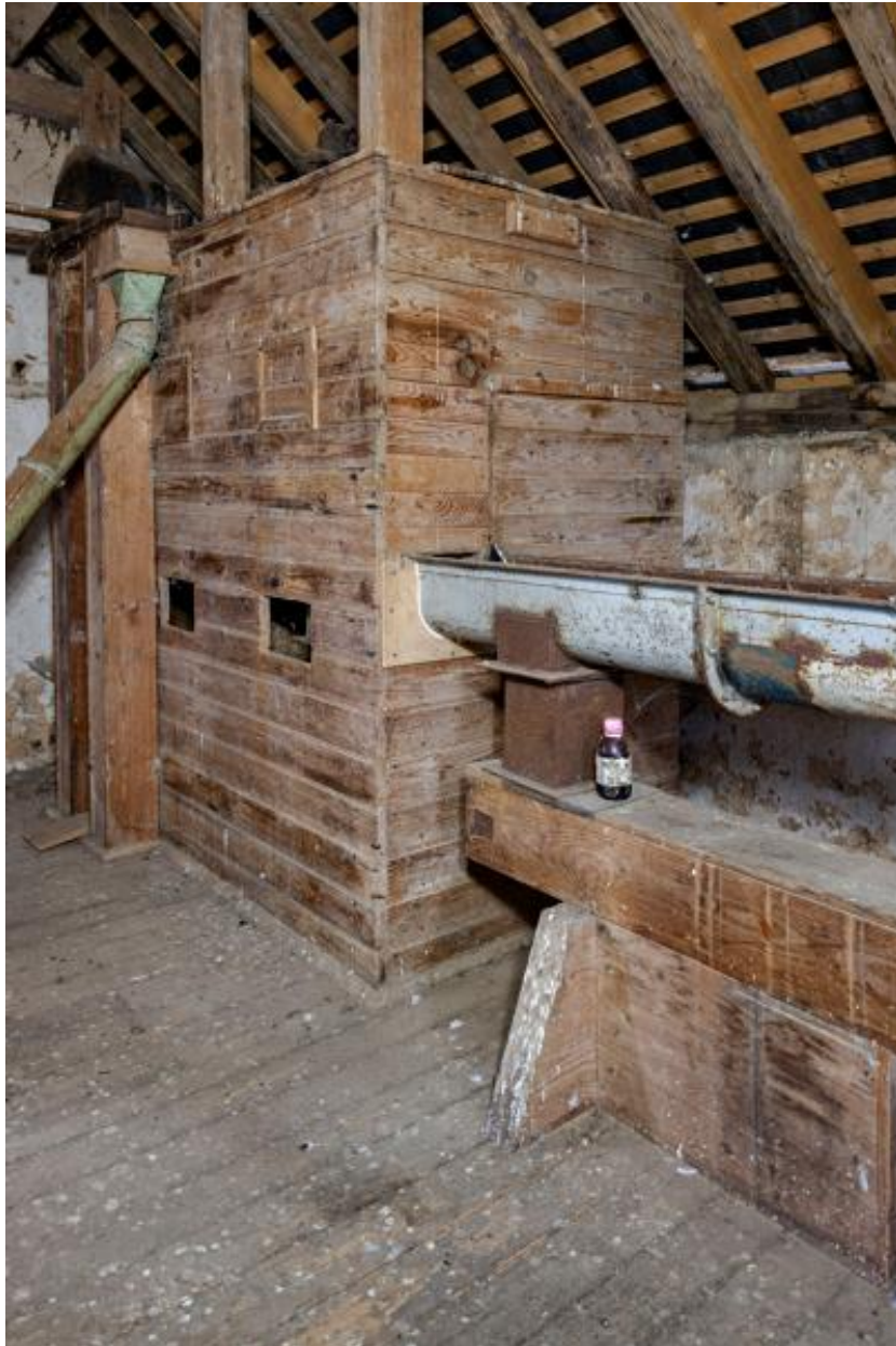
Étage en surcroît, partie nord-est vue depuis le sud-ouest : la chambre à blé propre.
