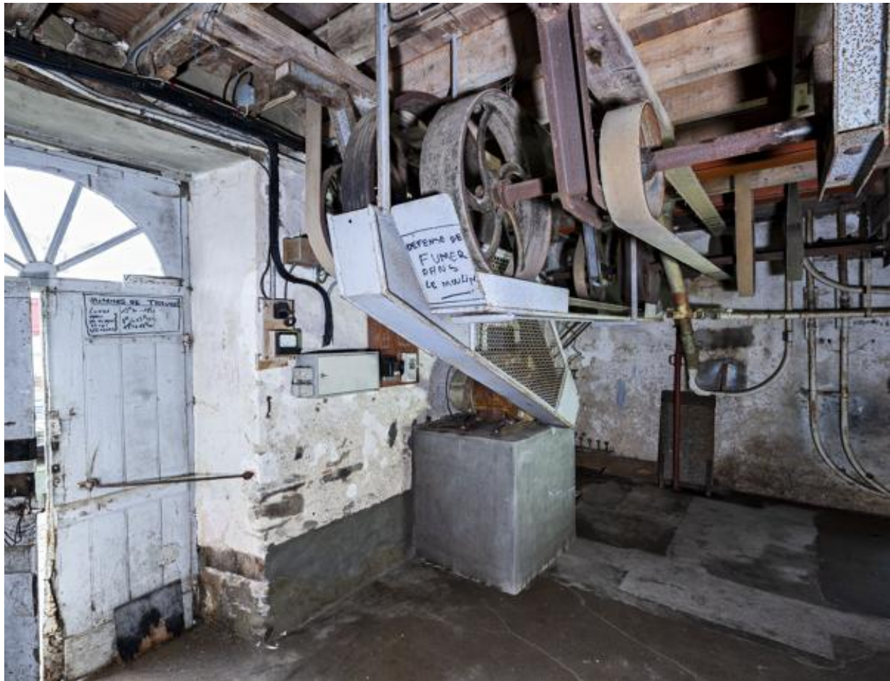
Rez-de-chaussée, partie nord-ouest vue depuis le sud : le moteur et les courroies transmettant le mouvement issu de la roue hydraulique et de ce moteur aux broyeurs à cylindres.
