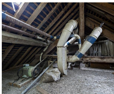
Comble, partie nord vue depuis le sud : soufflerie du système pneumatique. Elle est actionnée par un moteur de la marque CEM (Cie électro-
