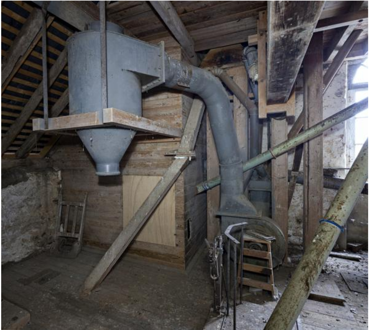
Étage en surcroît, partie sud-est vue depuis le nord : la chambre à blé sale et le récupérateur de poussière.
