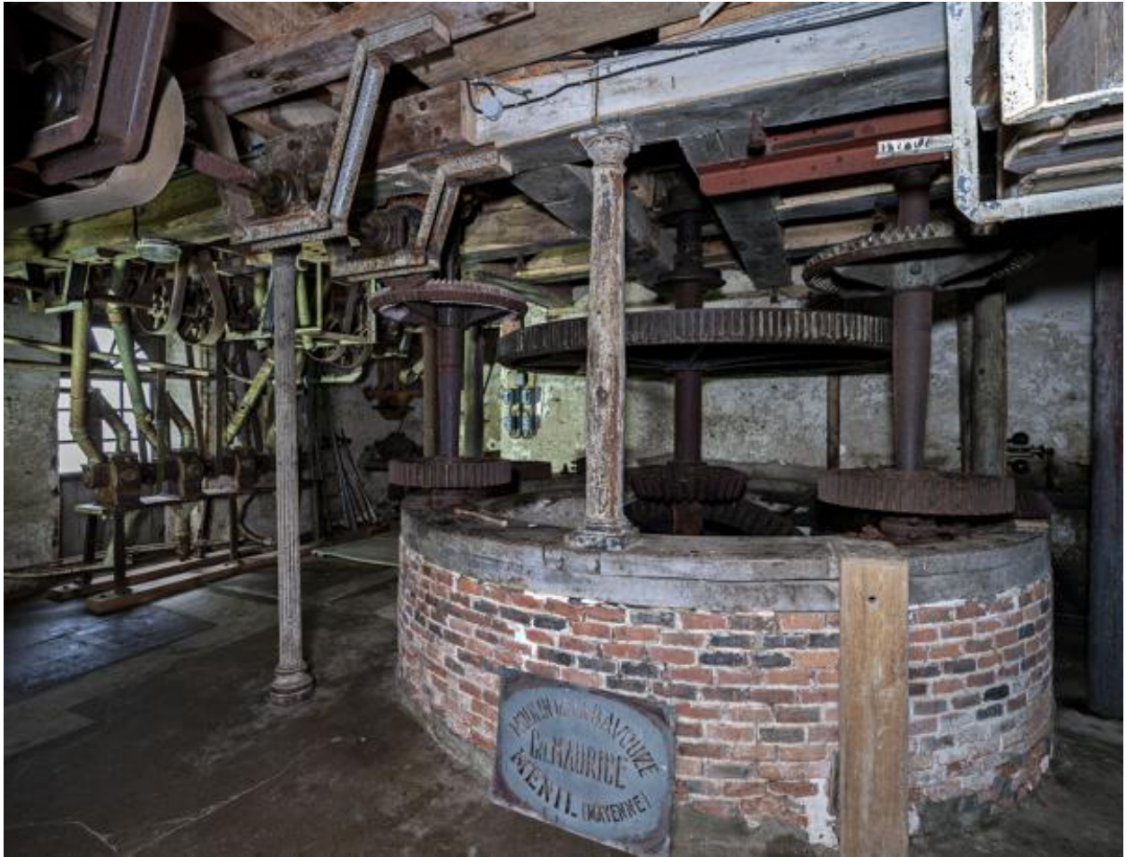
Rez-de-chaussée, partie nord-est vue depuis le sud-ouest : la poquerie contenant le système de transmission du moulin. Au fond, les conduites pneumatiques.
