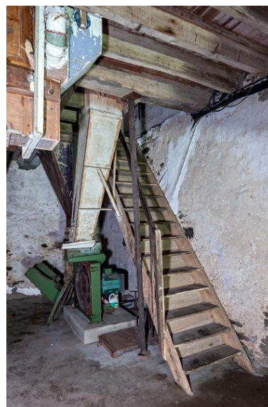
Rez-de-chaussée, partie sud-ouest : l'escalier et le broyeur à marteau utilisé pour l'orge (marque PROMIL, type B4C, N° 9252, date : 27/9/71). Phot. Yves Guillotin IVR52_20205300029NUCA
