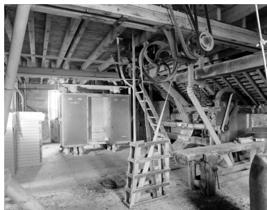
Étage en surcroît, partie nord, en 2002 : le plansichter de la marque Schneider, Jaquet et Cie, installé en 1976, le mouilleur à blé et la chambre à blé propre. Au premier plan, les courroies actionnant le monte-sac.
