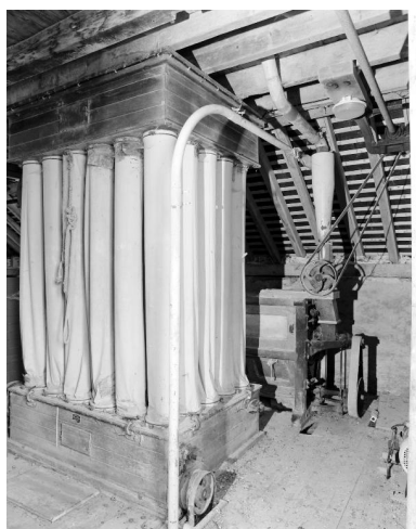
Étage en surcroît, partie nord-ouest, en 2002 : le filtre à air de la marque Ph. Lafon ; au second plan, la bluterie à son.
