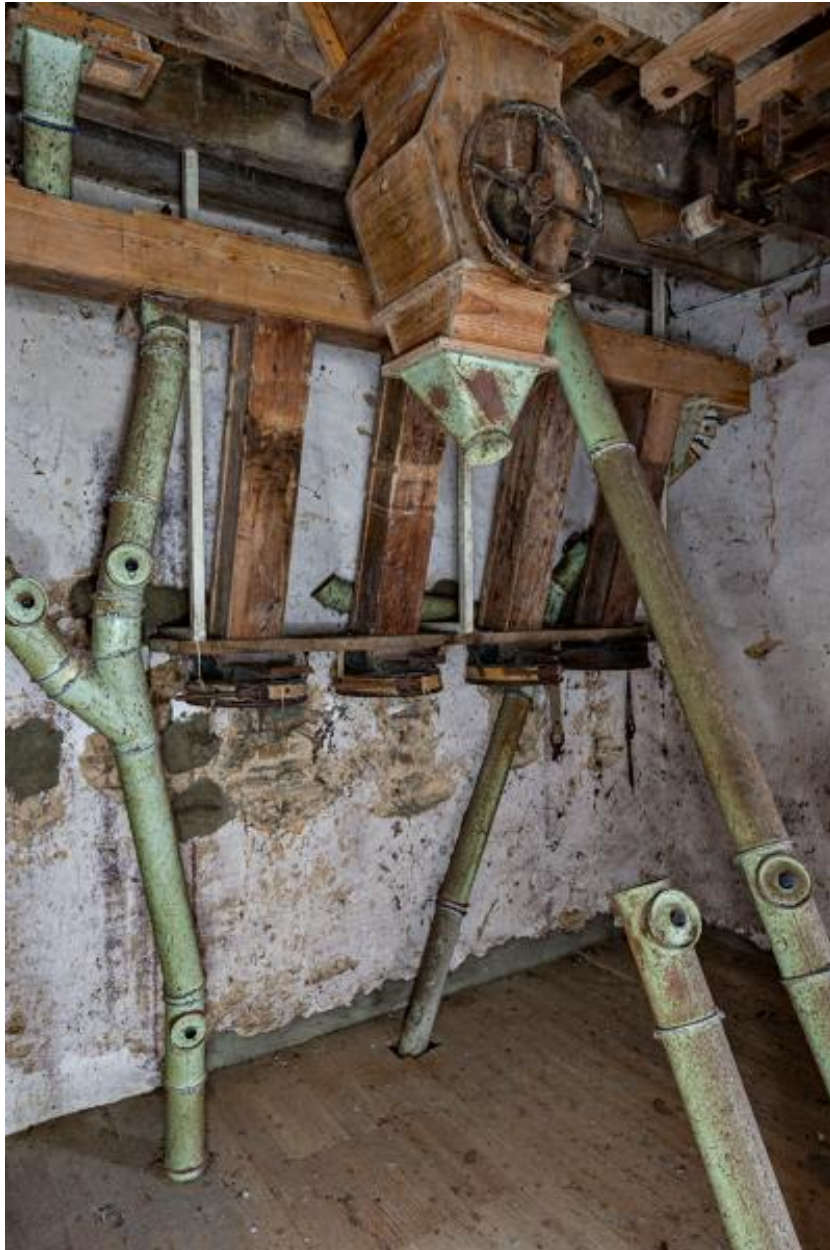
Deuxième étage, partie nord-ouest : les ensacheurs à son vus depuis le sud-est.
