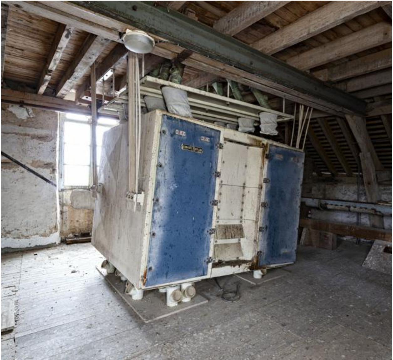
Étage en surcroît, partie nord : le plansichter vu depuis le sud-ouest.
