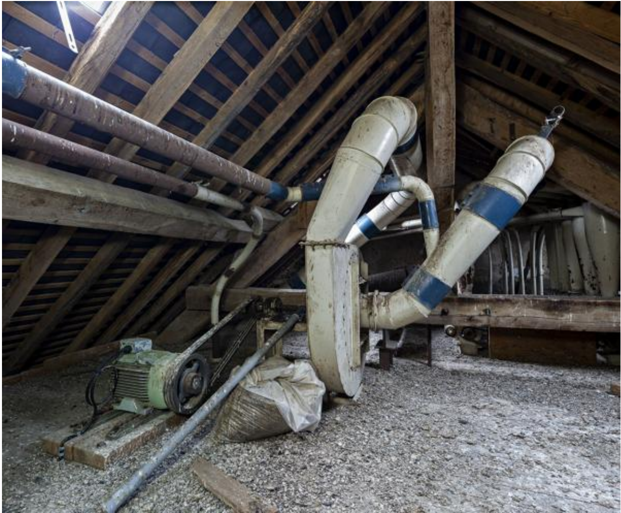
Comble, partie nord vue depuis le sud : soufflerie du système pneumatique. Elle est actionnée par un moteur de la marque CEM (Cie électro-mécanique) : moteur asynchrone n°7563993, METT 132MH4.
