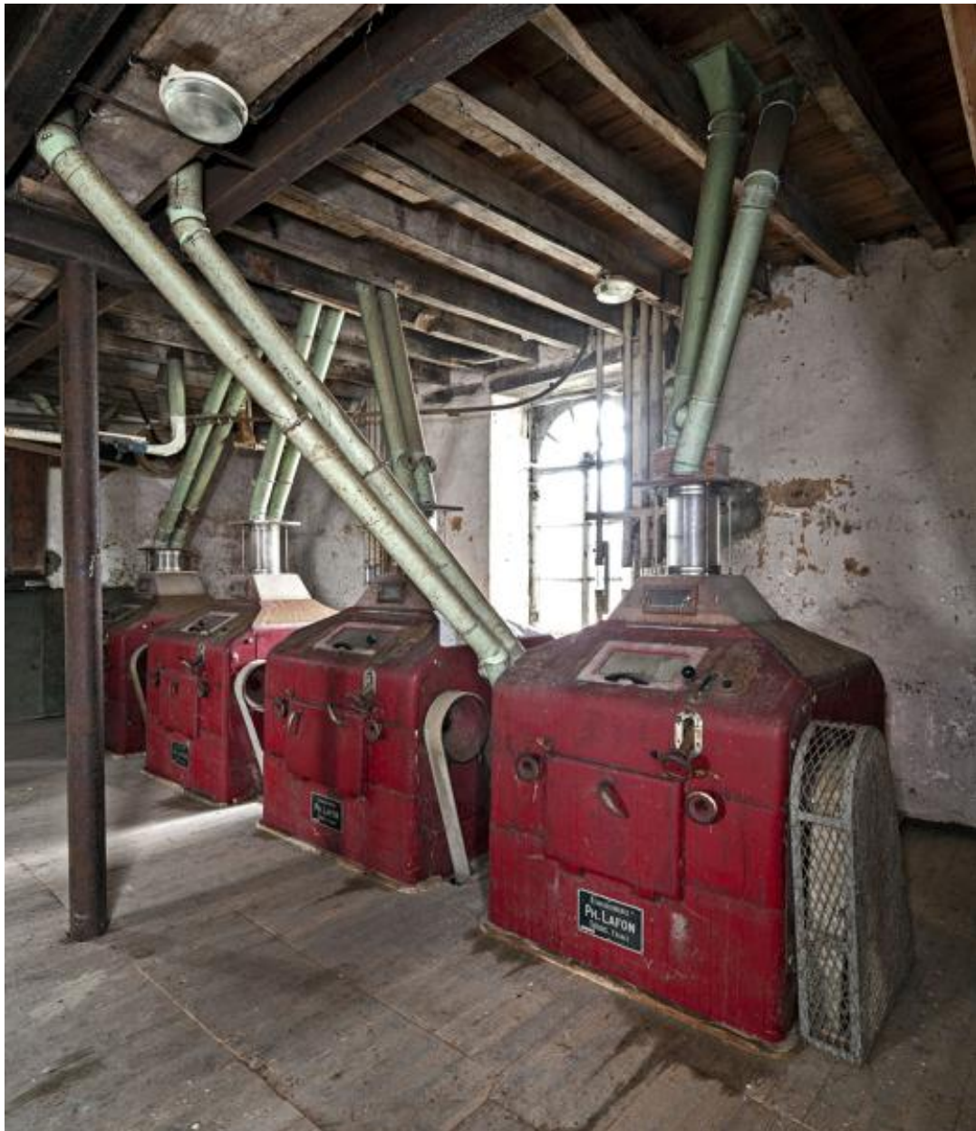
Premier étage, partie nord vue depuis le sud-est : les broyeurs à cylindres.
