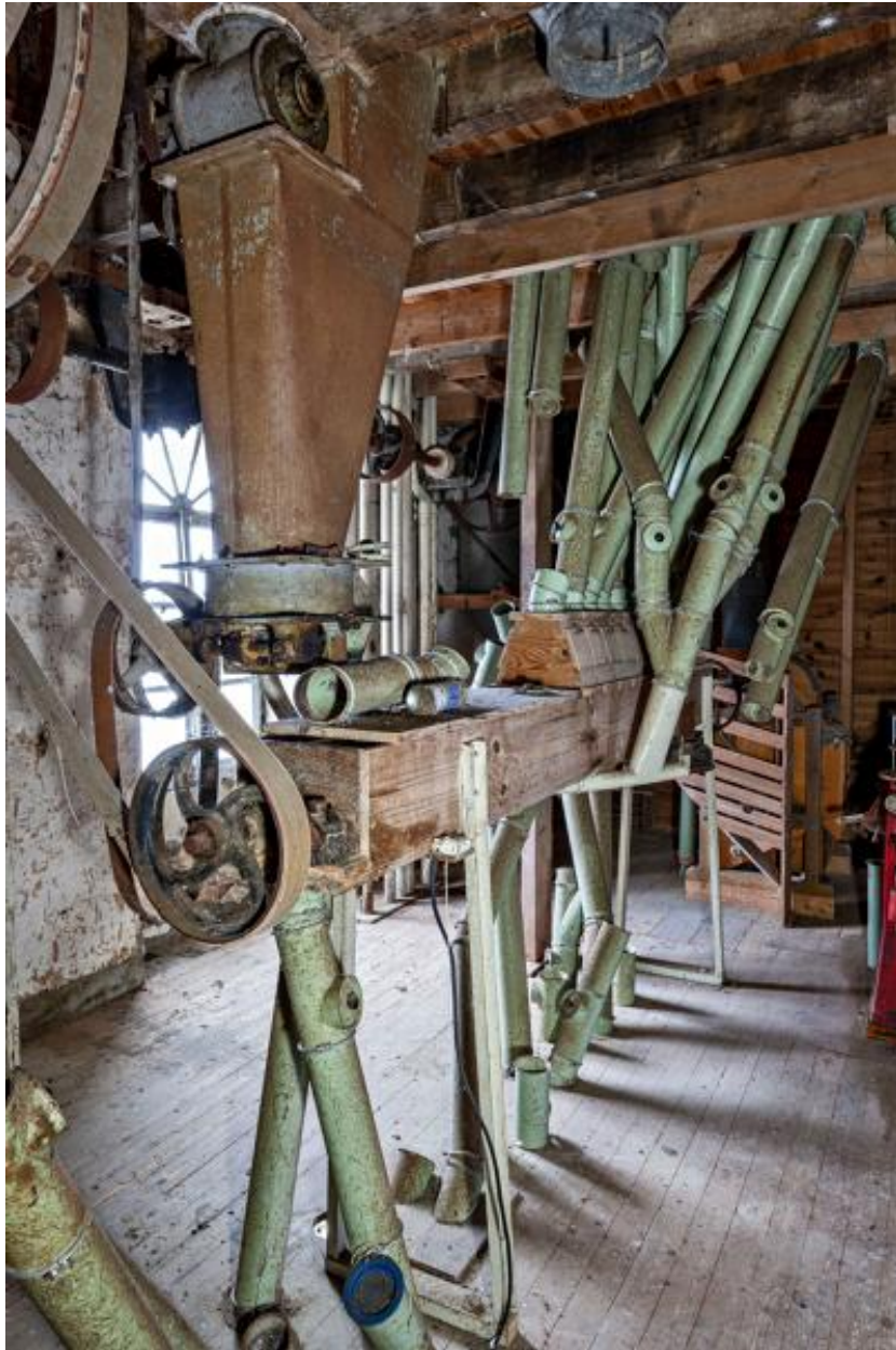
Deuxième étage, partie nord vue depuis l'ouest : l'ensacheur récupérant la farine venant du filtre à air situé au-dessus et les conduites pneumatiques reliant les broyeurs au plansichter.
