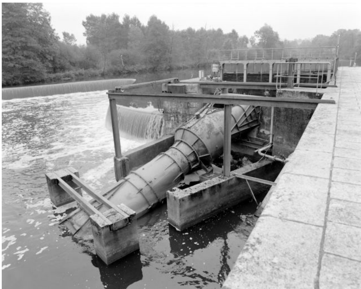
La micro-centrale électrique.
