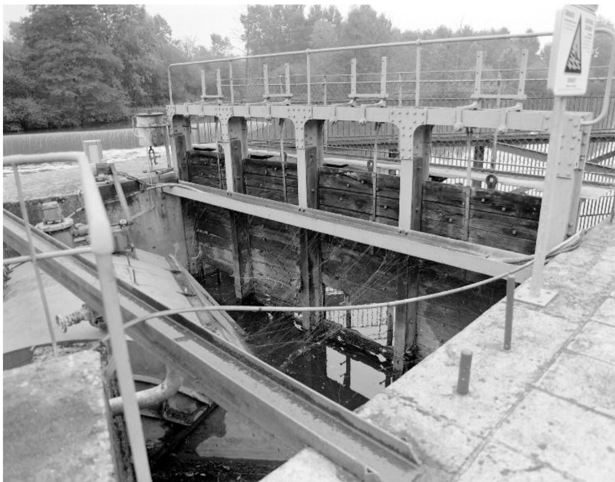
Le pertuis contre lequel s'appuie la micro-centrale électrique.
