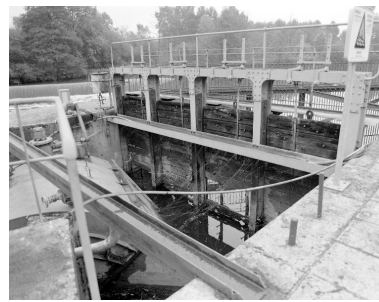
Le pertuis contre lequel s'appuie la micro-centrale électrique. Phot. François Lasa IVR52_20025301224X
