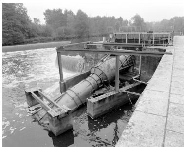
La micro-centrale électrique. Phot. François Lasa IVR52_20025301223X
