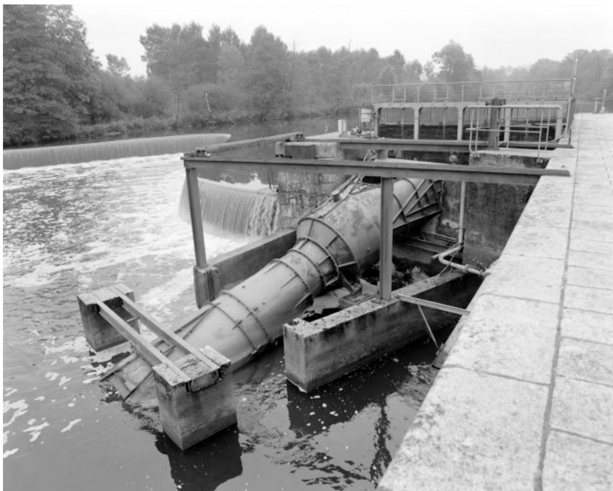
La micro-centrale électrique.
