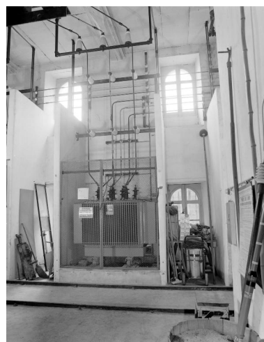
Le transformateur, situé au rez-de-chaussée de l'ancien moulin. Phot. François Lasa IVR52_20015300517X
