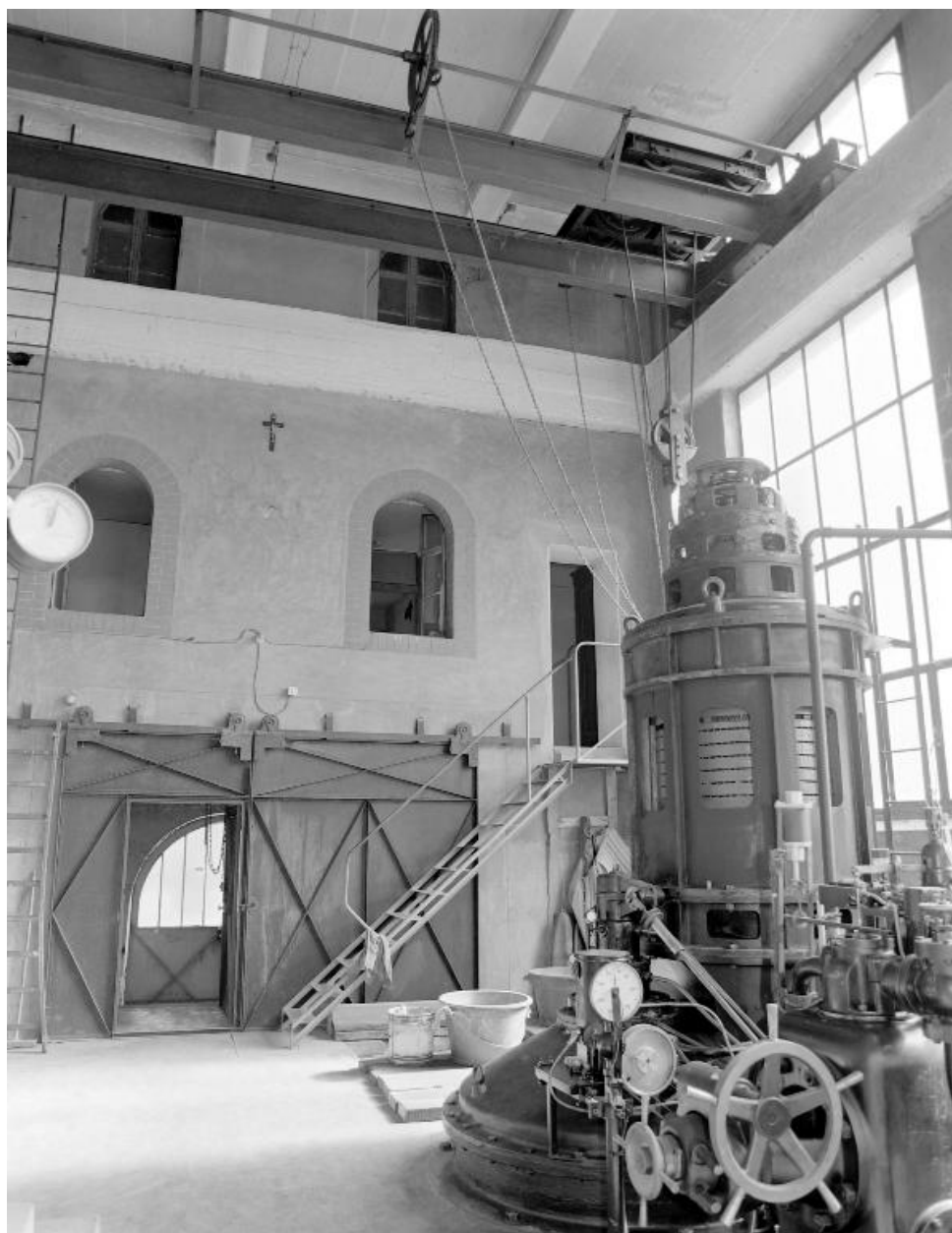
La salle des machines vue de l'ouest : machine énergétique, treuil et rail du plafond coulissant.
