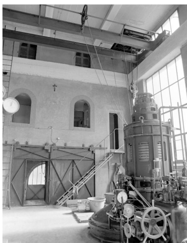
La salle des machines vue de l'ouest : machine énergétique, treuil et rail du plafond coulissant. Phot. François Lasa IVR52_20015300516X
