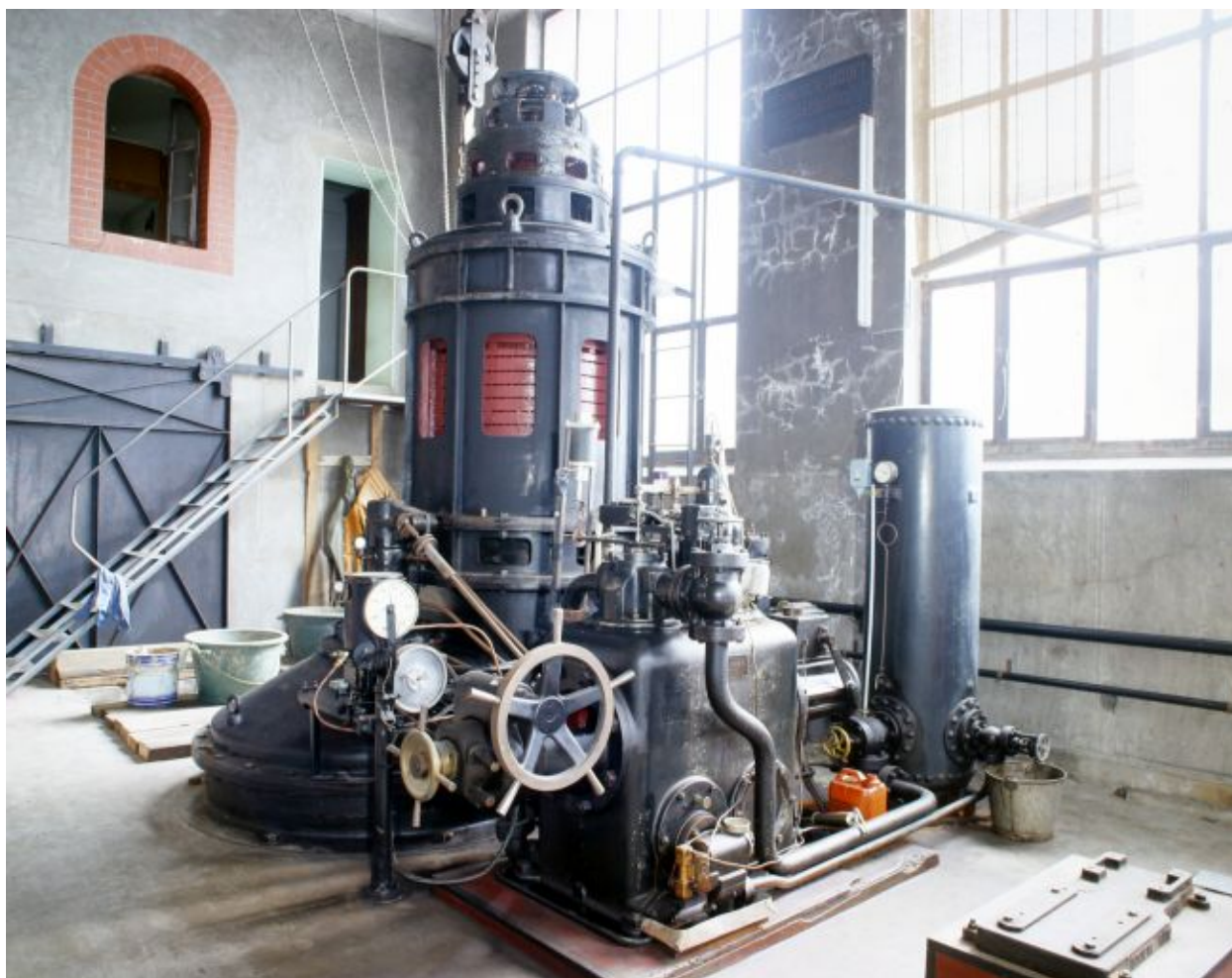
Machine énergétique, comprenant le régulateur de la turbine, l'amplificateur et le générateur électrique alternatif.
