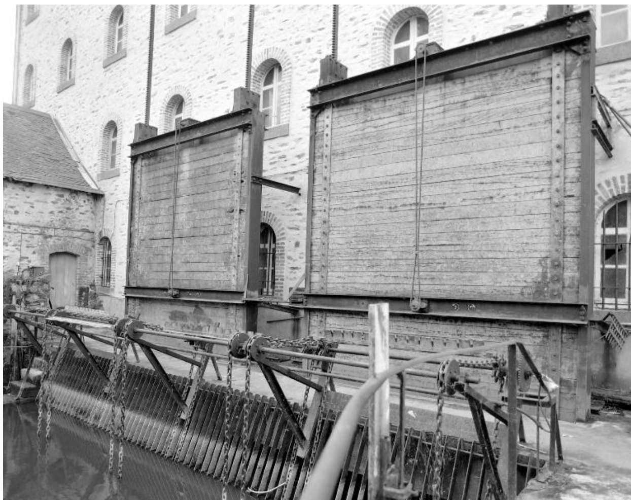
Les vannes motrices situées sur le flanc nord du moulin.
