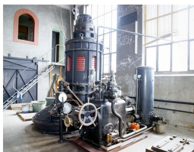
Machine énergétique, comprenant le régulateur de la turbine, l'amplificateur et le générateur électrique alternatif. Phot. François Lasa IVR52_20015300672XA
