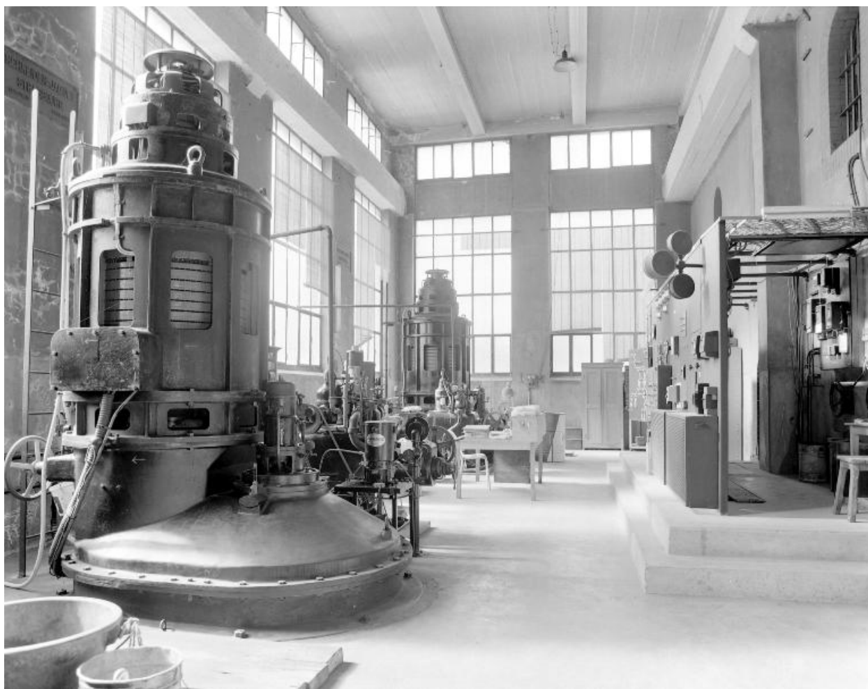
La salle des machines. Vue d'ensemble depuis l'entrée est : à gauche, les deux machines énergétiques ; à droite, le tableau de commande.
