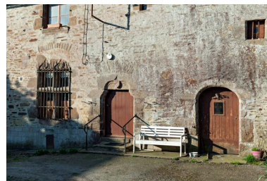
Rez-de-chaussée de la façade sud du manoir de Glandsemé. Phot. Yves Guillotin IVR52_20195300521NUCA
