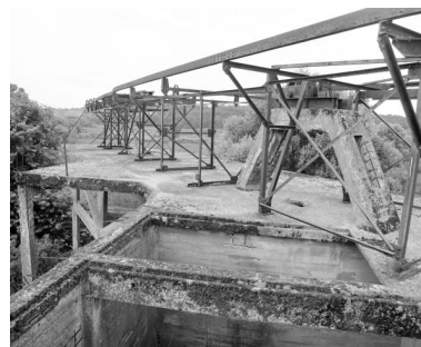
Vue générale de la station d'arrivée du transporteur automatique par câbles (état en 1997). Phot. Bernard Renoux IVR52_19974402660X
