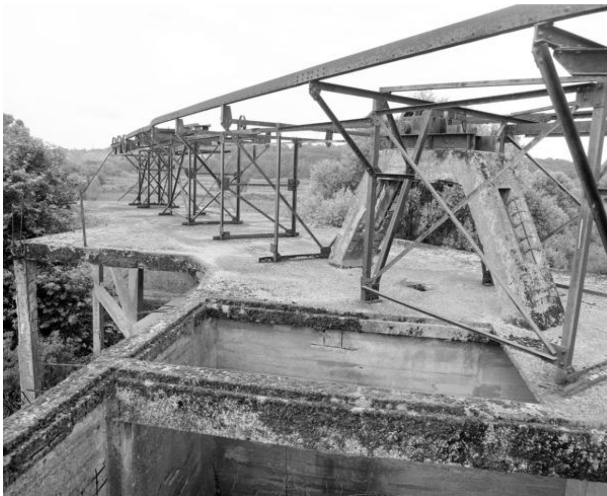
Vue générale de la station d'arrivée du transporteur automatique par câbles (état en 1997).
