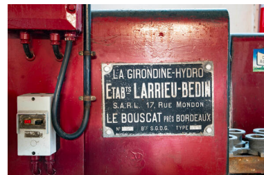
Détail de la plaque du fabricant. Phot. Pierre-Bernard Fourny IVR52_20224400385NUCA
