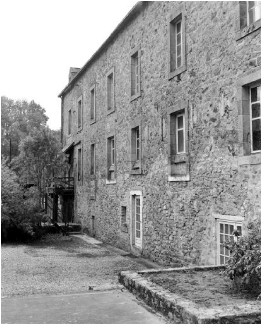
Façade postérieure de l'ancien moulin à farine. A gauche, la vanne régulant l'alimentation en eau d'une des turbines.
