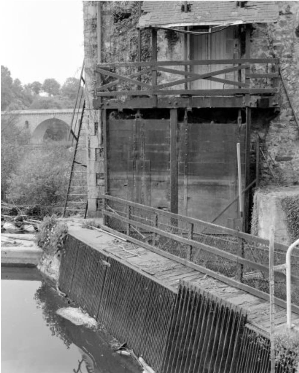
Vanne motrice controlant l'alimentation en eau de la turbine est située sous l'ancien moulin.
