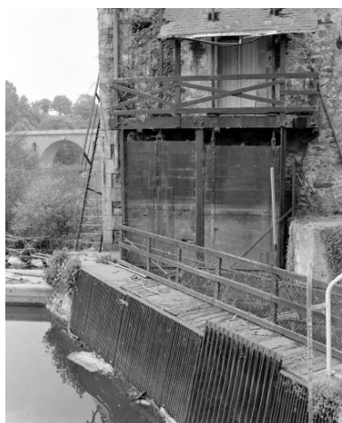
Vanne motrice contrôlant l'alimentation en eau de la turbine est située sous l'ancien moulin. Phot. François Lasa IVR52_19985300077X
