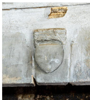
La cheminée de la salle du rez-de-chaussée, détail de l'écu. Phot. Pierre-Bernard Fourny IVR52_20225300418NUCA
