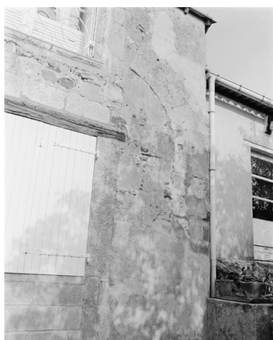
Façade postérieure de l'aile en retour d'équerre nord, détail d'un passage muré. Phot. Bruno Rousseau IVR52_19854901795X
