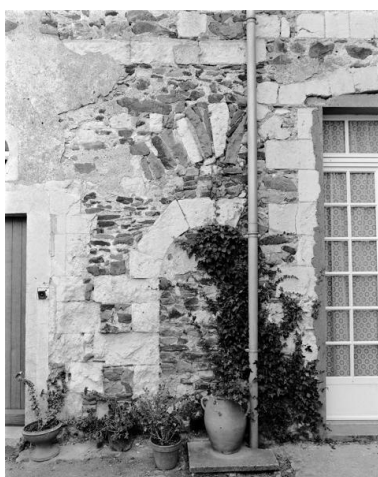
Façade antérieure du corps de logement, partie droite, détail d'ouvertures murées. Phot. Bruno Rousseau IVR52_19854901792X
