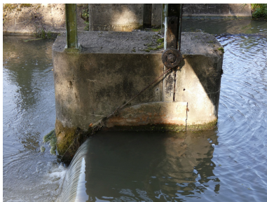
Mécanisme d'une des deux vannes levantes. Phot. Yannis Suire IVR52_20228501135NUCA
