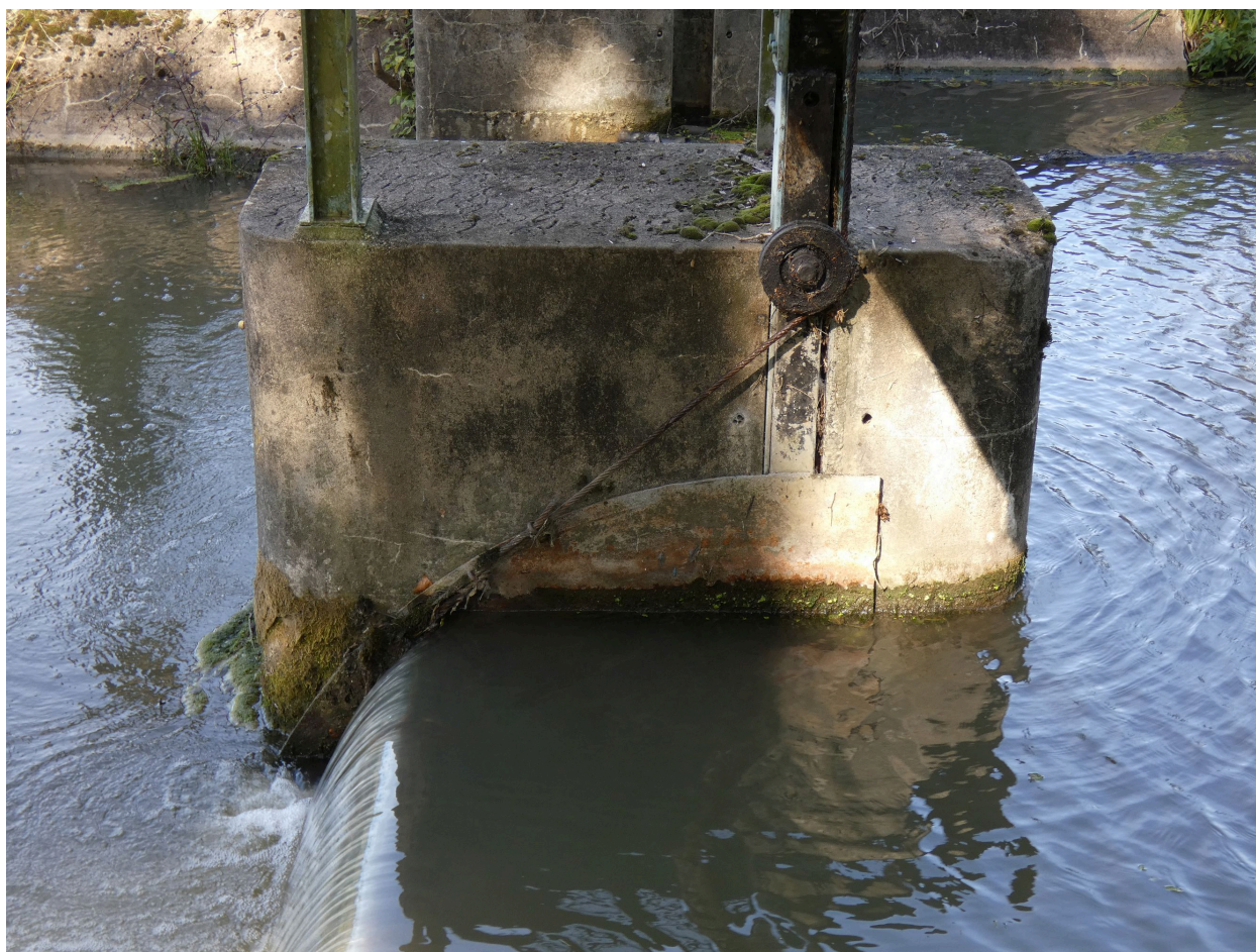
Mécanisme d'une des deux vannes levantes.
