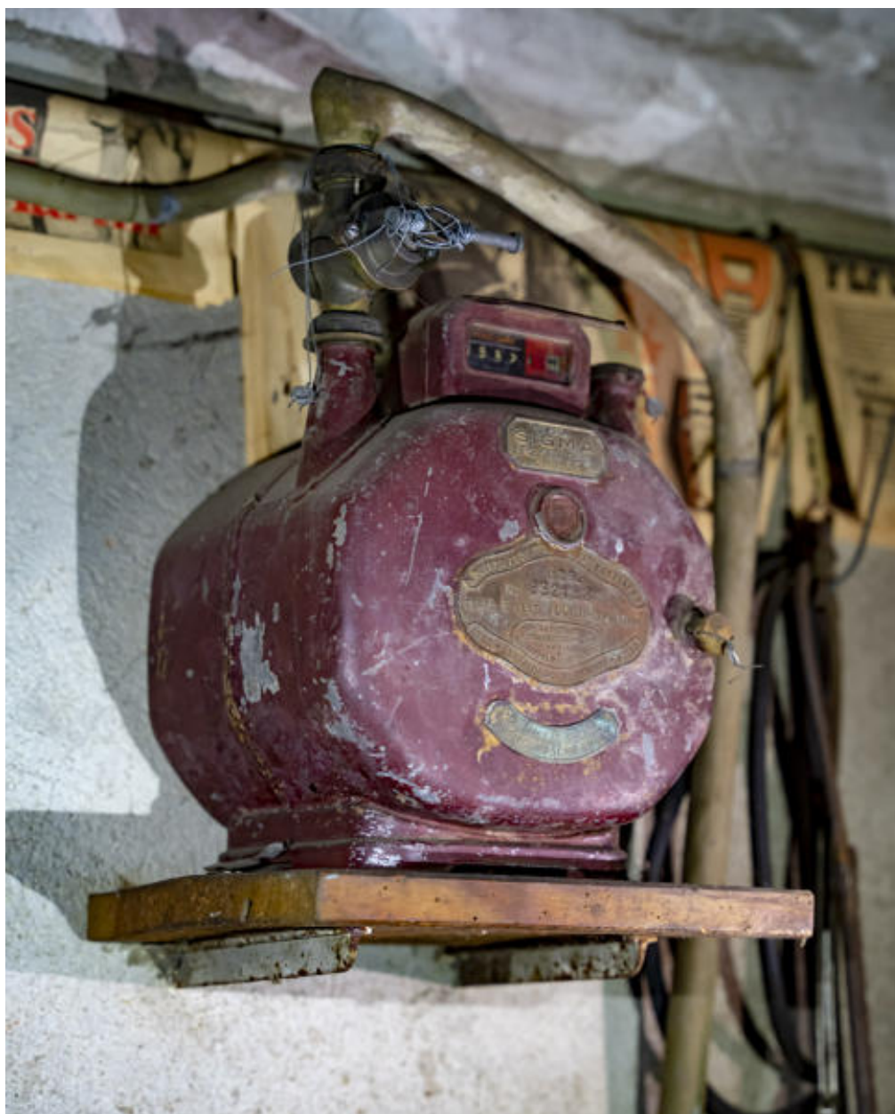
Vue du compteur d'eau dans un pavillon rue Icare.
