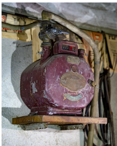
Vue du compteur d'eau dans un pavillon rue Icare. Phot. Pierre-Bernard Fourny IVR52_20217200639NUCA
