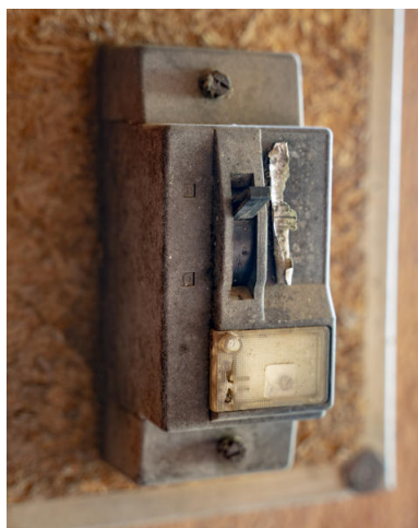
Vue du tableau électrique dans un pavillon rue Icare. Phot. Pierre-Bernard Fourny IVR52_20217200636NUCA
