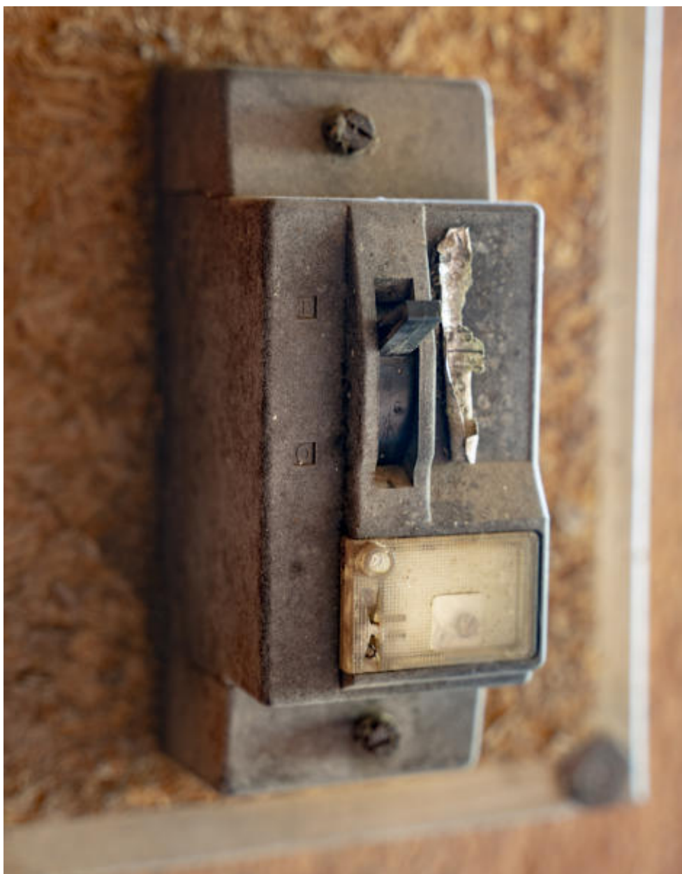
Vue du tableau électrique dans un pavillon rue Icare.
