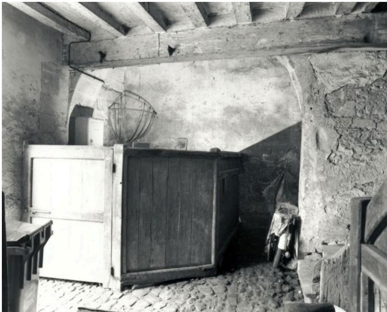
Bâtiment des écuries, rez-de-chaussée, face intérieure vers la rue : arc de liaison avec le corps d'entrée.
