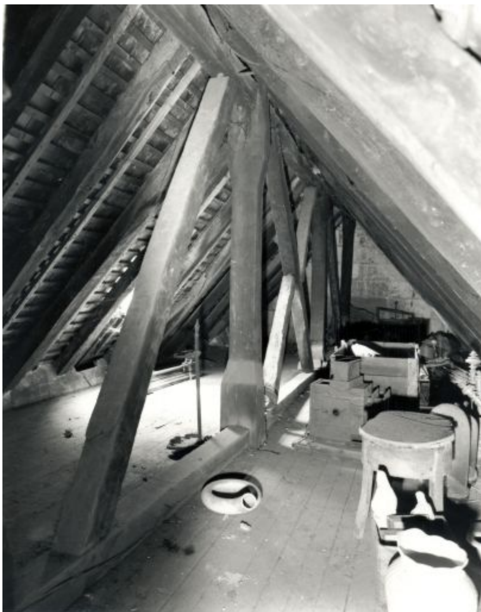
Corps de logis principal : partie supérieure du comble, en axe longitudinal, de la droite vers la gauche.
