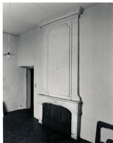
Bâtiment des écuries, rez-de-chaussée, pièce d'habitation droite, mur latéral gauche : cheminée. Phot. François Lasa
