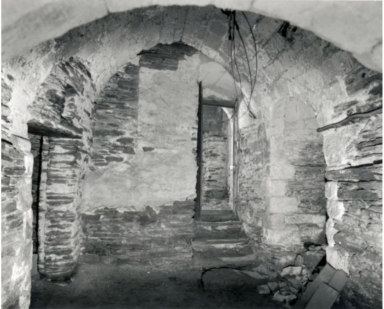
Corps de logis gauche : cave droite en axe longitudinal. A gauche, porte d'accès à un escalier de sortie vers la cour (maintenant condamné). Au fond, porte d'accès à la cave gauche. A droite, passage voûté menant à un puits.
