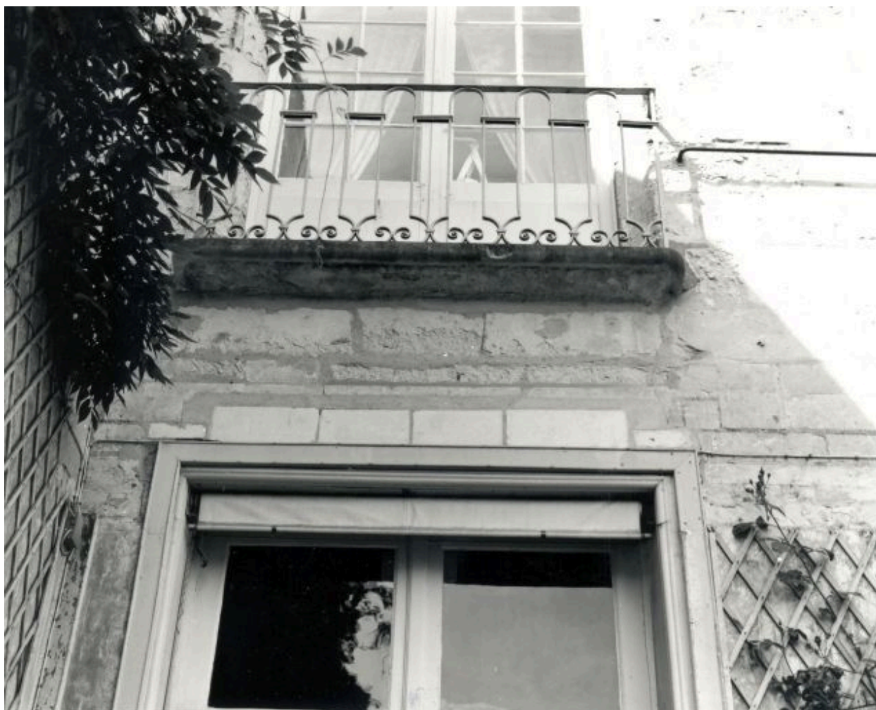
Corps de logis principal, élévation postérieure sur jardin, rez-de-chaussée : vestiges de la plate-bande de l'ancienne baie gauche.
