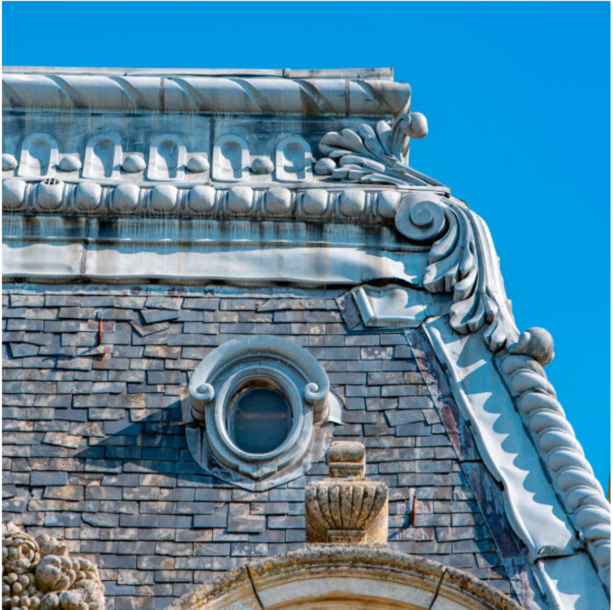
Le pavillon sud-est, détail de la couverture et du décor en zinc.
