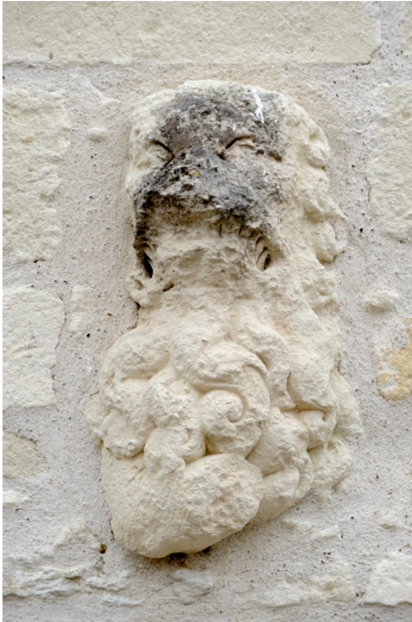
Tête de Lion (vers 1504-1506), provenant de la Porte d'En-Bas de l'abbaye de Fontevraud, en emploi dans le mur de la façade sur rue.
