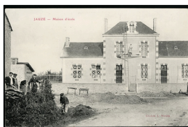
La mairie-école en construction en 1906. Autr. L. Vivien, Phot. François (reproduction) Lasa IVR52_20077200586NUCA
