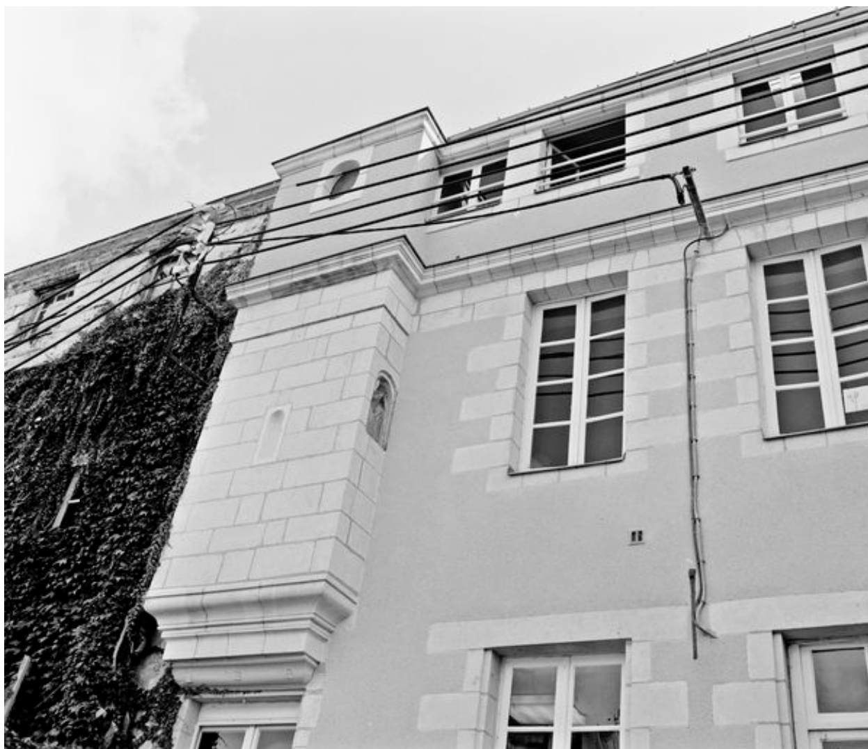
Aile sud du logement des religieux : façade ouest sur jardin remployée dans un lotissement de demeures : partie située 16 quai des Carmes, détail sur les baies d'étages et l'échauguette.
