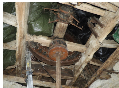
Détail du mécanisme sous le toit : la lanterne, le rouet et l'arbre. Phot. Yannis Suire IVR52_20188501142NUCA
