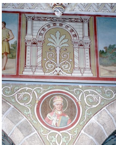
Pré-en-Pail, Mayenne, nef de l'église Notre-Dame. Louis Renouard a peint en 1885 les scènes à l'huile sur le mur et les médaillons également à l'huile en atelier avant de les maroufler. Phot. Patrice Giraud IVR52_20005300069XA
