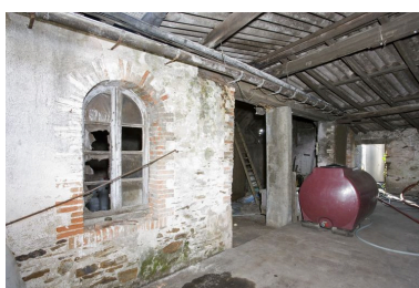
Cellier, fin 18e siècle (?), remanié au 19e siècle : façade éventrée. Phot. Yves Guillotin IVR52_20104402831NUCA
