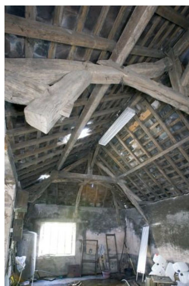
Cellier : charpente aux arbalétriers sectionnés lors du remaniement. Phot. Yves Guillotin
