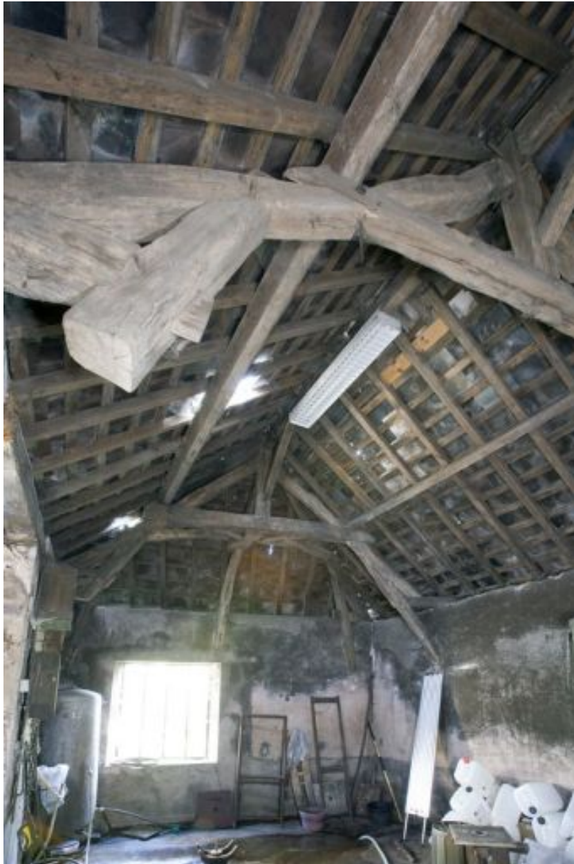
Cellier : charpente aux arbalétriers sectionnés lors du remaniement.
