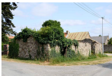
Edifice agricole en ruine situé au sud des logis du Plessis Pasquier. Phot. Armelle Maugin IVR52_20254900645NUCA
