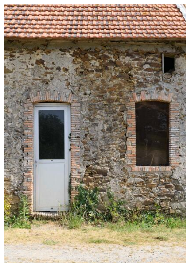
Détail des encadrements en briques d'un des logis du Plessis Pasquier. Phot. Armelle Maugin IVR52_20254900650NUCA
