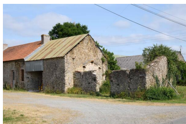
Détail de la grange et d'un édifice en ruine situés à l'extrémité des logis du Plessis Pasquier. Phot. Armelle Maugin IVR52_20254900644NUCA
