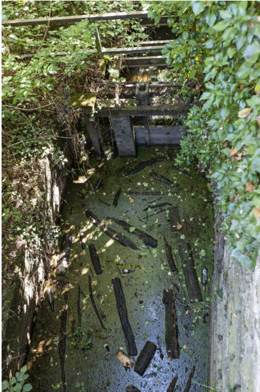
L'emplacement de la turbine, envoyée, vue depuis l'étage du moulin, en 2018.
