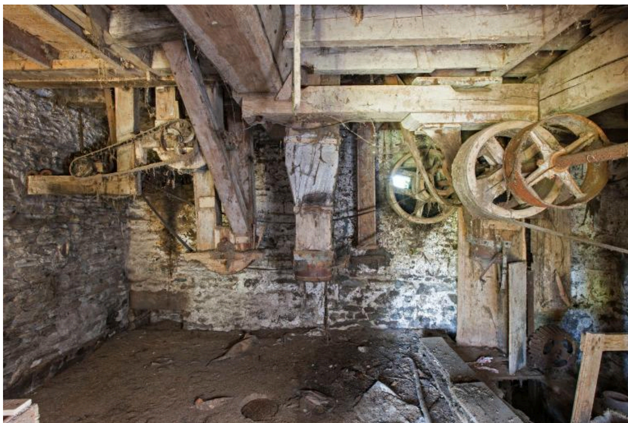
Rez-de-chaussée du moulin : vue depuis le sud de l'élévateur à godets nord et de l'ensacheur à aplati. A droite, l'axe horizontal et les courroies de transmission.
