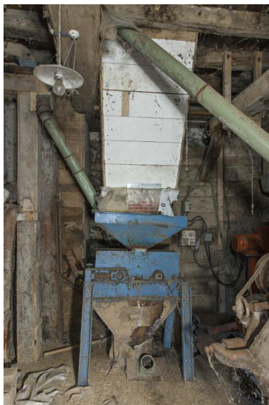
Premier étage du moulin, angle nord-est : aplatisseur vu depuis le sud. Phot. Yves Guillotin IVR52_20185300414NUCA
