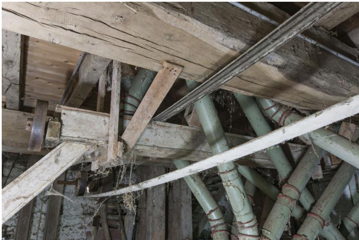
Premier étage du moulin : vue rapprochée des conduits métalliques assurant la descente des céréales vers les broyeurs.
