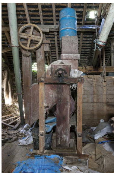
Comble du moulin, angle nord-ouest : élévateur à godets nord et nettoyeur à grains vus depuis le sud. Phot. Yves Guillotin IVR52_20185300423NUCA
