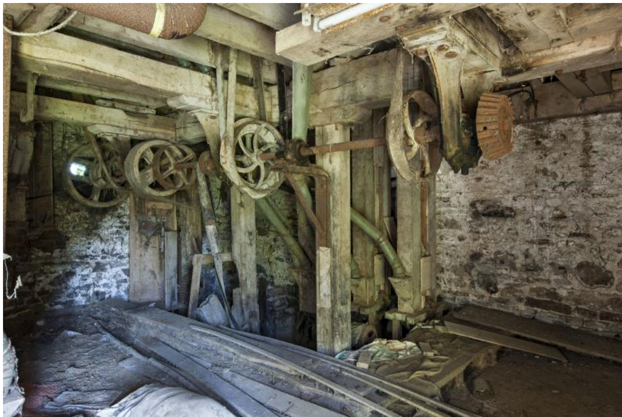
Rez-de-chaussée du moulin : vue depuis le sud-ouest de la fosse contenant la turbine, de l'axe horizontal et des courroies de transmission, des élévateurs à godets et conduites est.
