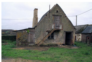
Vieille maison : pignon ouest reconstruit avec chaînage de grosses briques. Phot. Jean-Baptiste Darrasse IVR52_20097200933NUCA
