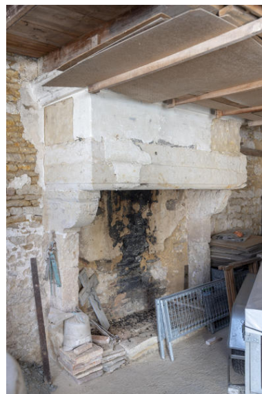
Cheminée dans la remise. Phot. Pierre-Bernard Fourny IVR52_20218502022NUCA
